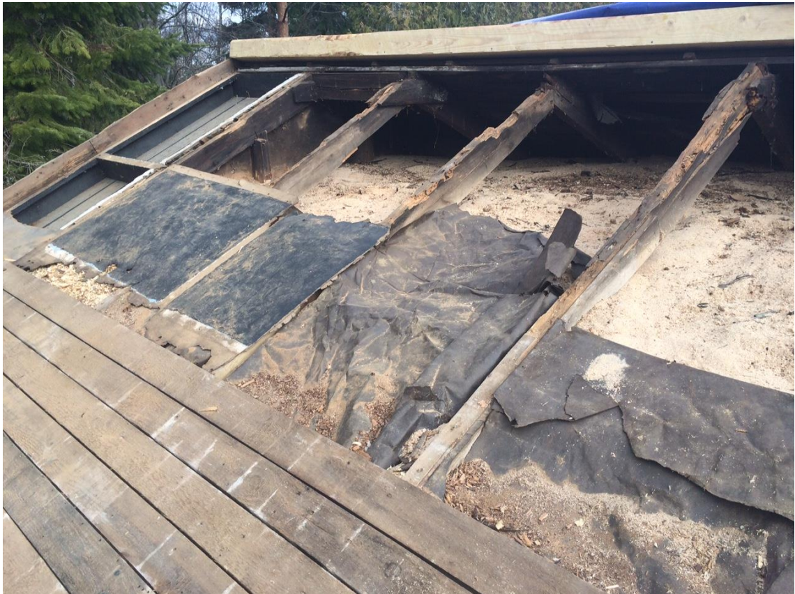
KUVA 1. Yläpohjan puuttuvan tuuletuksen seurauksia
