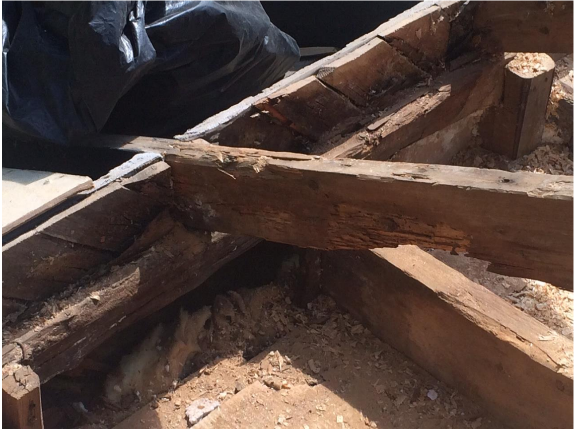
KUVA 2. Umpeen rakennettujen kattolappeiden seurauksia
