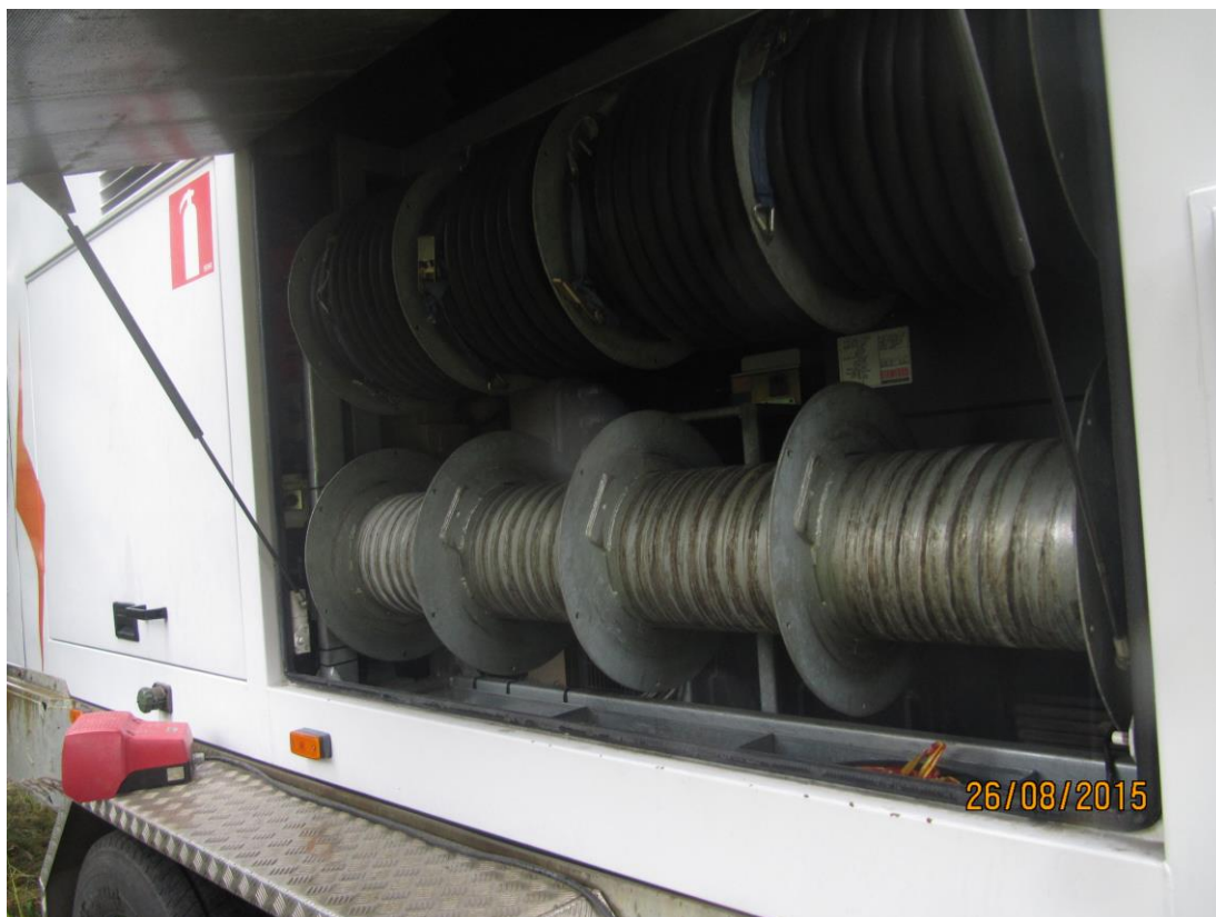
Kuva 8. Varavoimakoneen PJ-johtojen kaapelikelat.
