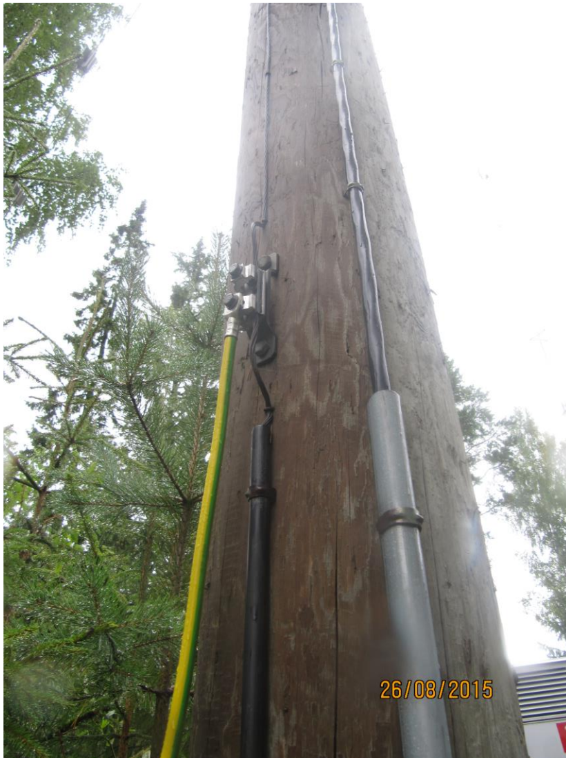
Kuva 9. Syöttömuuntajan maadoituksen kytkentä pylvään maadoituspisteeseen.
