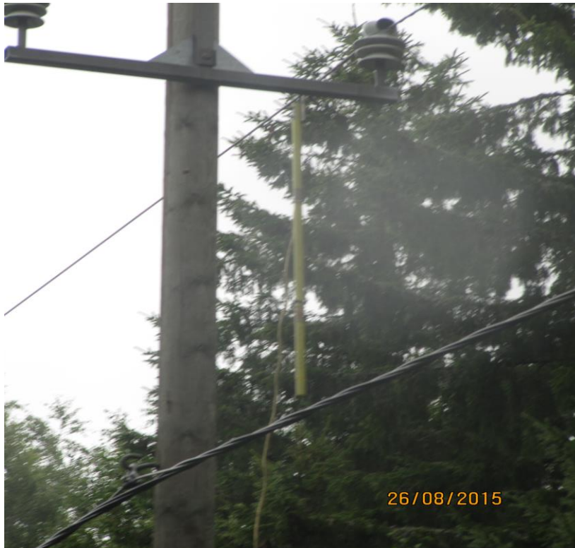
Kuva 15. Sauva asennettuna 20 kV:n johtoon maasulkukoetta varten.
