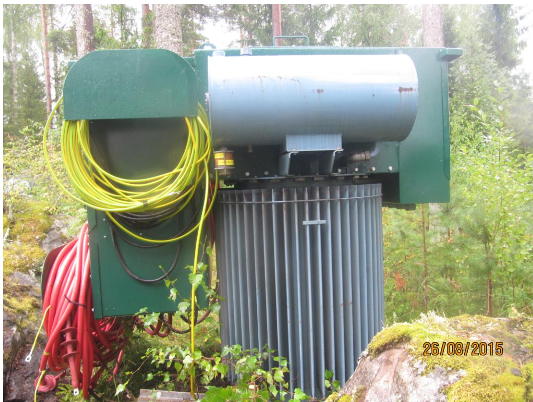
Kuva 7. 0,4 kV/20 kV:n Syöttömuuntaja.
