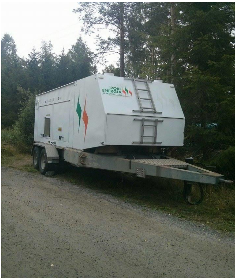
Kuva 4. Pori Energia Sähköverkot Oy:n 1000 kVA:n varavoimakone.
