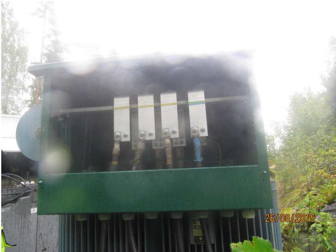
Kuva 11. Syöttömuuntajan PJ-johdojen kytkentä. 20 kV:n johdot on syöttömuuntajalla valmiiksi jo kytketty.
