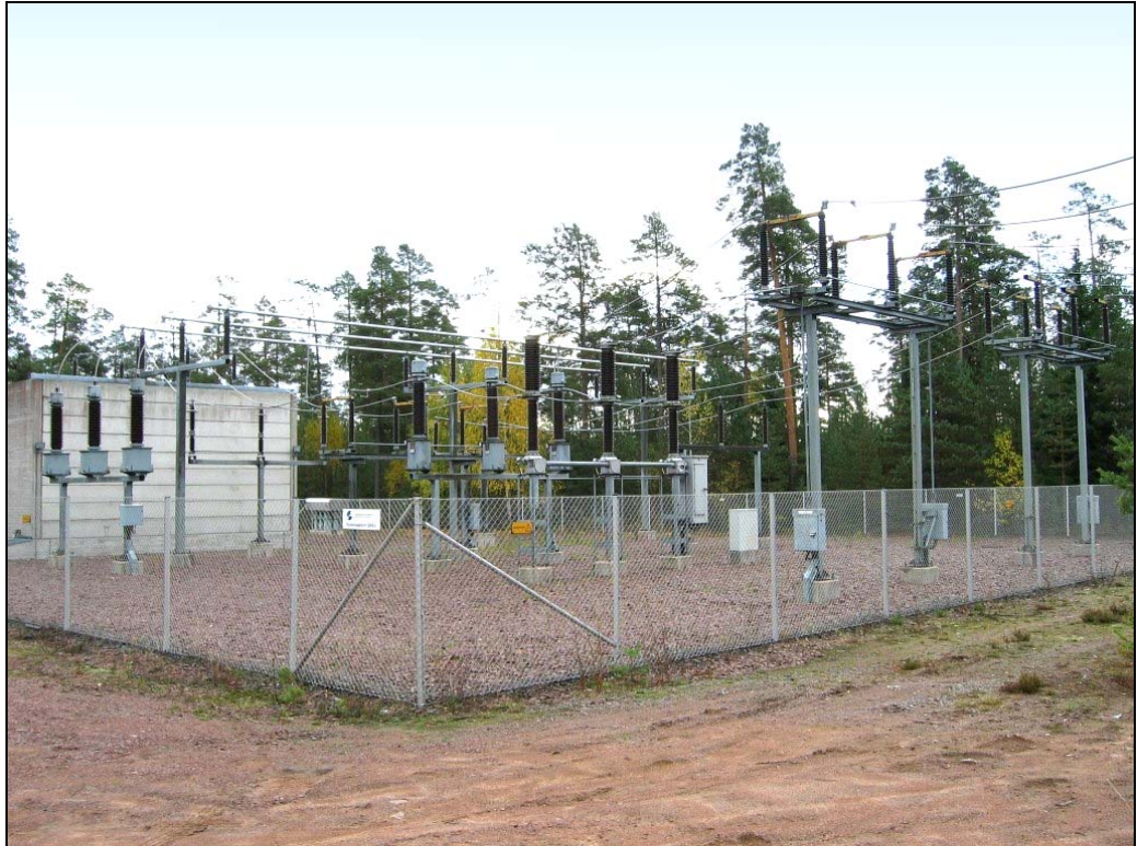
Kuva 1. 110 kV:n Petäjäsuo sähköasema Kotkassa.
