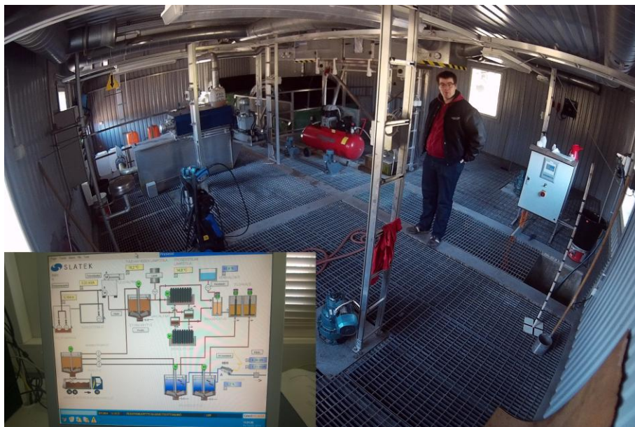
KUVA 1. Suomenniemen jäteveden puhdistamo ja valvomon näyttöpäätte
