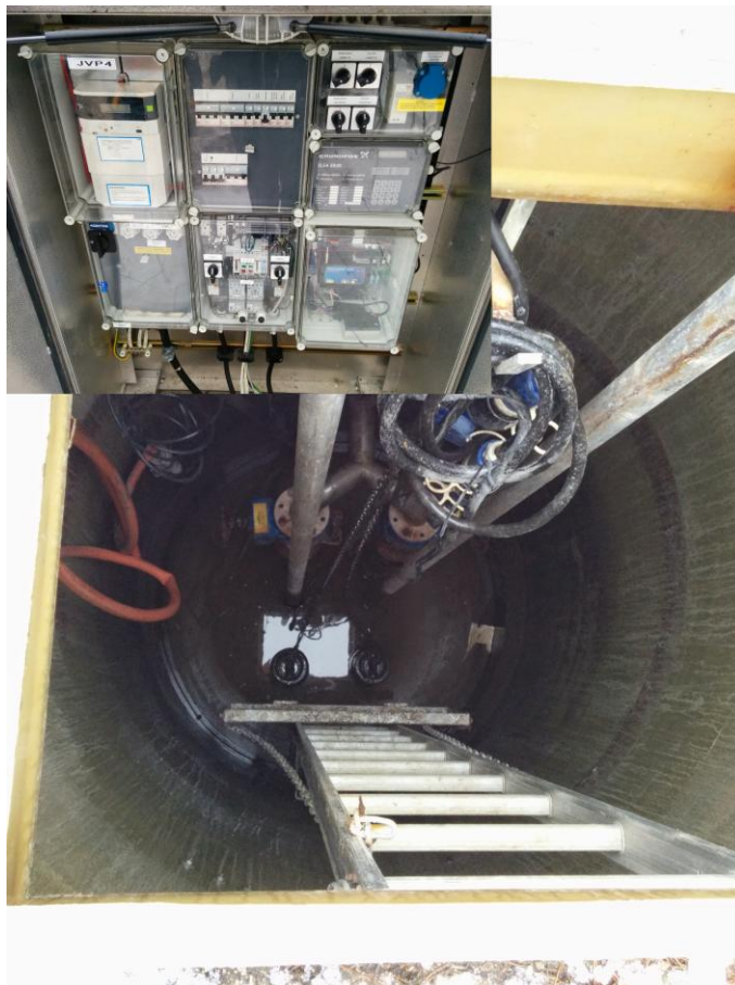
KUVA 8. Pumppaamo maanpäällisellä keskuksella
