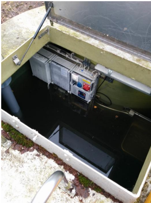
KUVA 7. Pumppaamo veden vallassa
