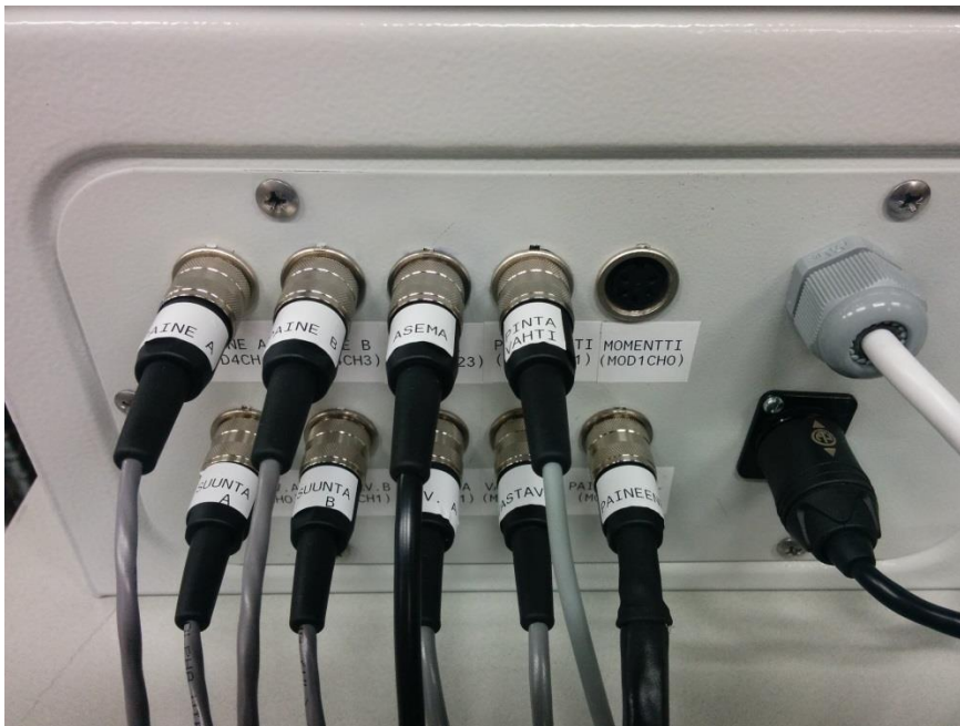
KUVA 6. Mittalaitteiston liitännät (Mikko Santala 20.8.2015)
