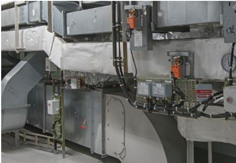
Kuva 9. 063A-moduulin sähkölaitteita ja kaapeliratoja (Meyer Turku Oy 2015).
