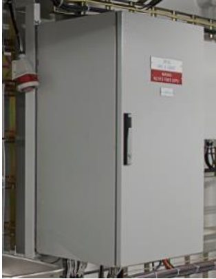
Kuva 10. HVAC-automatiikka-kaappi asennettuna asennuslevylle (Meyer Turku Oy 2015).
