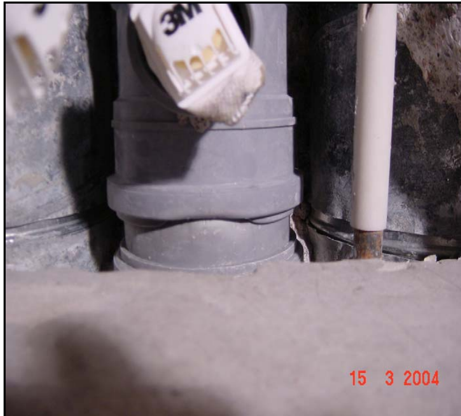
Kuva 5. Kuvassa on vääntynyt viemärin pää, joka on piikattu esiin.
