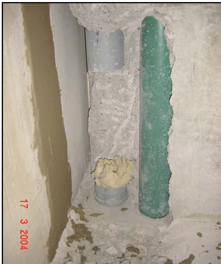
Kuva 16. Kuvauksissa ilmi tullut viemäriputken huono liitos purettuna.
