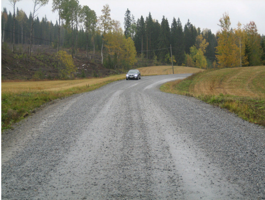
Kuva 20 Rämsöö-Härkälä 1.10.2008. Vastaava kohta kuin kuvassa 19, mutta Härkälään päin. Murske on lajittunut niin, että toimenpiteeksi harkittiin myös uudelleen tehtävää muotoiluhöyläystä. Kohdan kuntoarvo enintään 3. /15/
