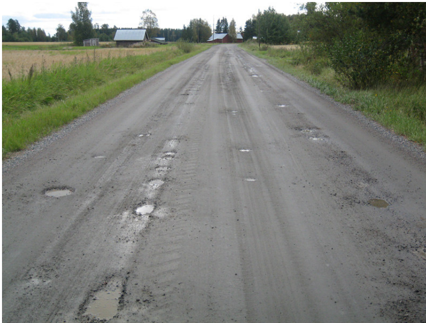
Kuva 21 Palojoentie 10.9.2008. Tiellä oli useissa kohtaa ajomukavuutta haittaavia reikäsarjoja. Reikien syvyys oli luokkaa 4-6 cm, ei kuitenkaan 25-30 cm kuten Liitoviestissä kerrottiin. Koko tien kuntoluokka on tasolla 2. /15/
