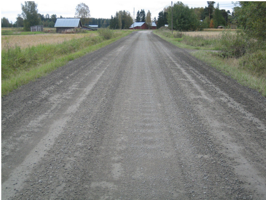
Kuva 22 Palojoentie 17.9.2008. Tie murskeen lisäyksen ja alusterätasauksen jälkeen. Sekä pinnan kiinteys että tasaisuus on tasolla 3. Alkava epätasaisuus "nimismiehenkihara" voi johtua siitä, että suoralla tiellä voitiin parantuneen pintakunnon takia lisätä nopeutta./15/
