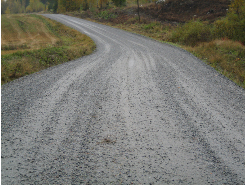
Kuva 19 Rämsöö-Härkälä 1.10.2008. Tie noin viikko sorastuksen jälkeen. Kohdassa kuntoarvo on yli 3. /15/
