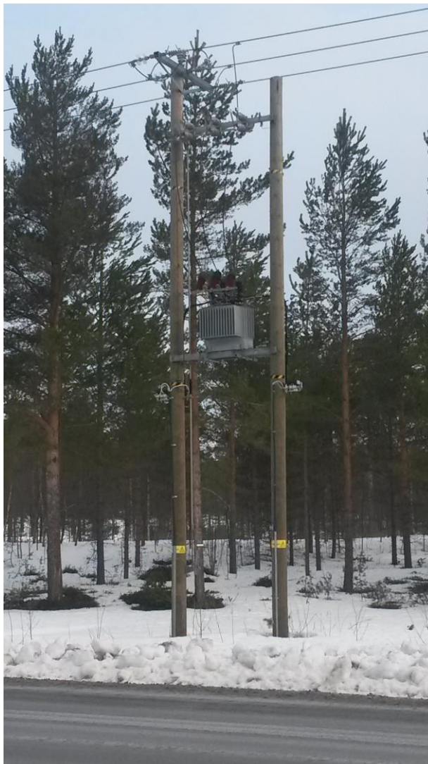
KUVIO 1. Pylväsmuuntamo 02094 Riipan pysäkki
