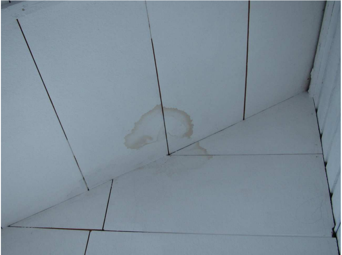
Kuvio 7. Vesikatteen vuoto kuistin kohdalla
