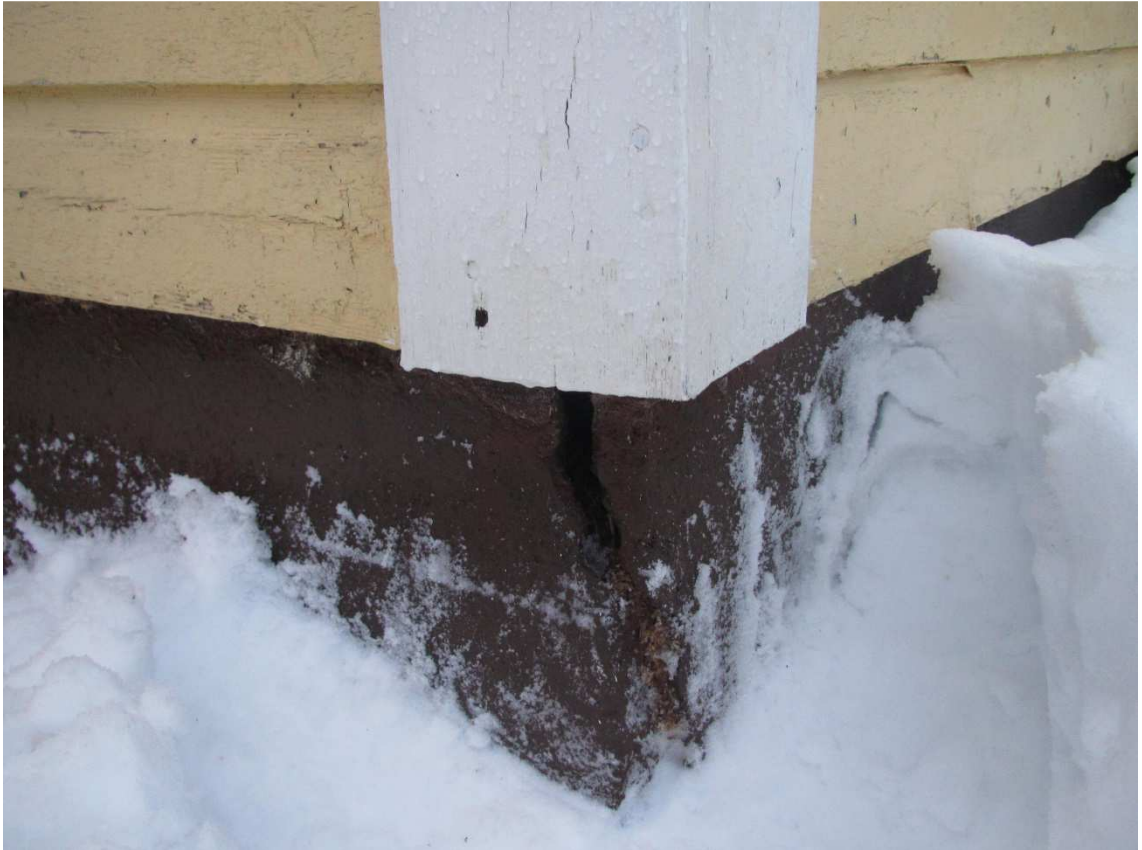
Kuvio 3. Halkeama perusmuurissa
