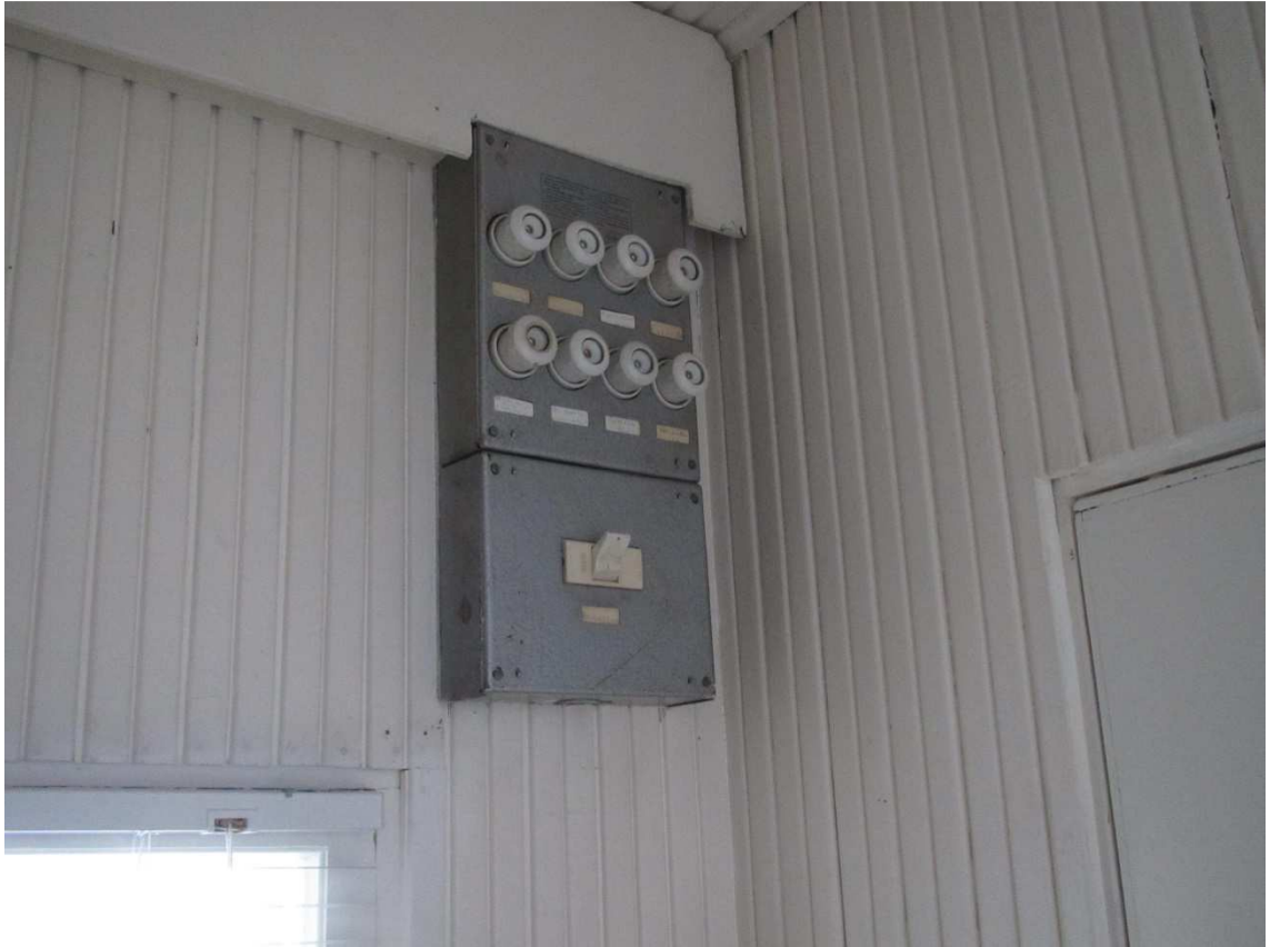
Kuvio 14. Rakennuksen sähkökeskus
