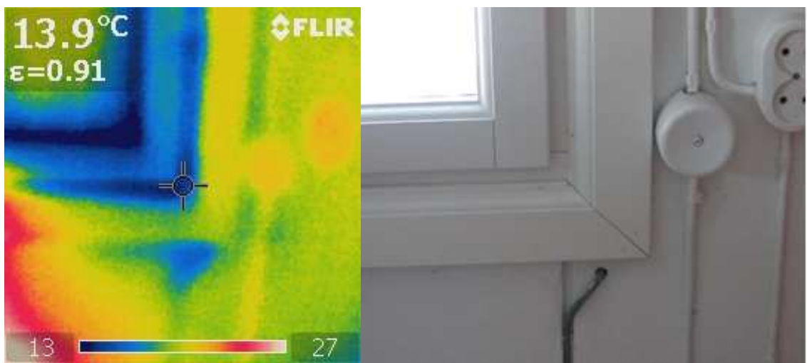
Kuvio 5. Olohuoneen ikkunan lämpövuoto (sininen väri)
