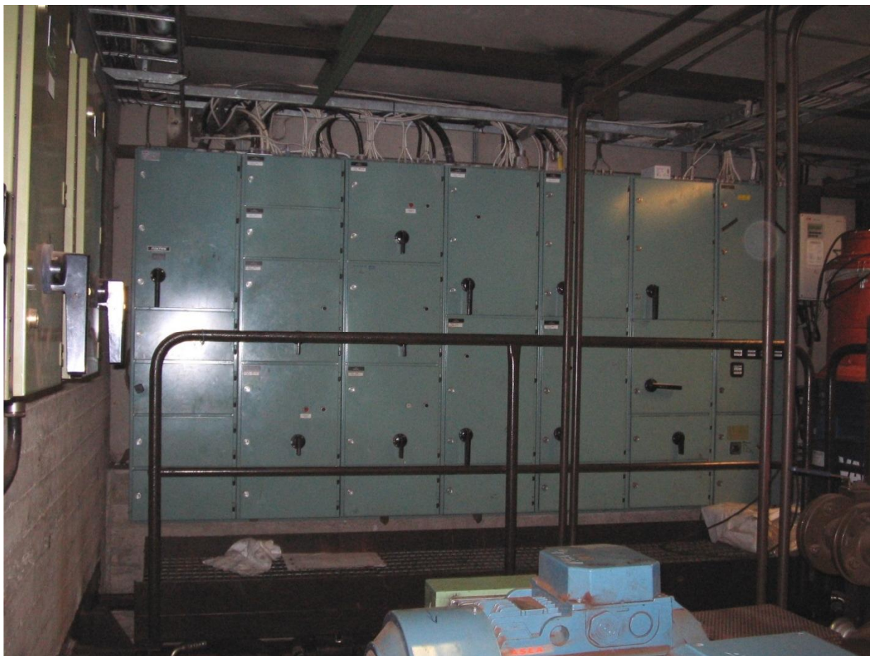
KUVA 3. Vanha sähkökeskus hydraulikkahuoneessa (Jukka Kauppinen 2015-02-23.)
