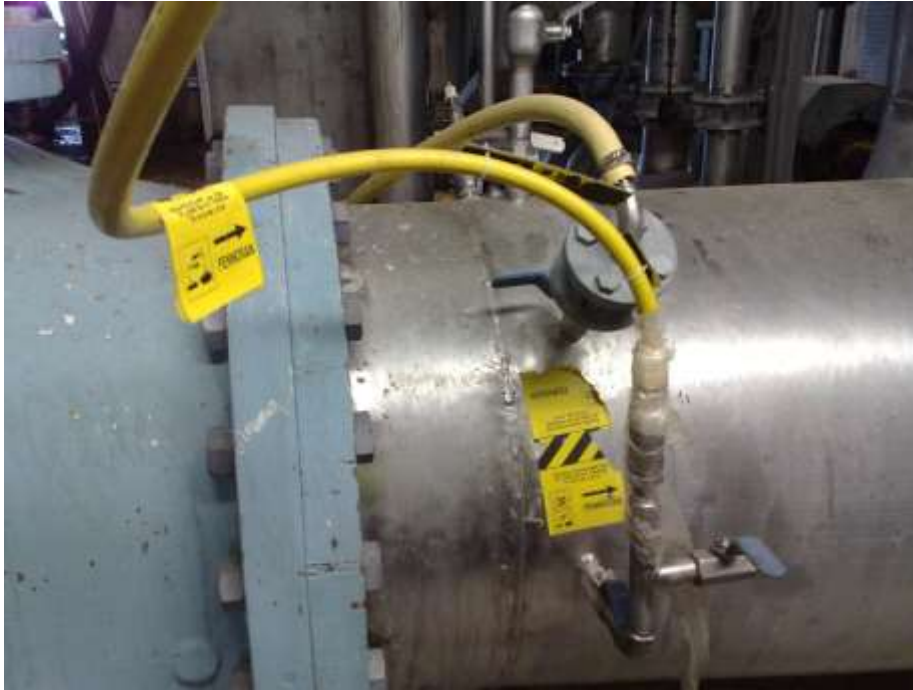
Kuva 11. Biosidiletkun vaarallinen asennus.
