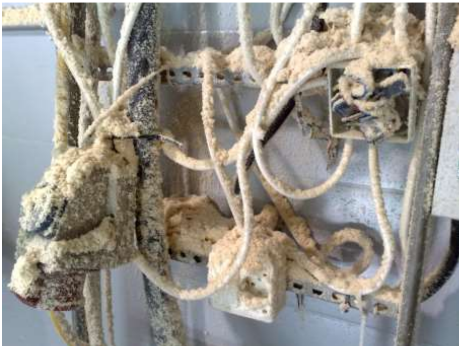
Kuva 14. Sähköturvallisuuden laiminlyönti voi aiheuttaa suuret vahingot.
