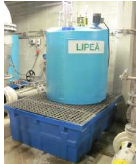
Kuva 5. Polyeteenistä valmistettu turva-allas
