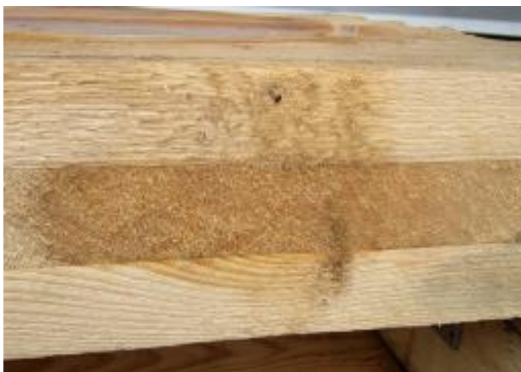
Kuva 36. Vaakasuunnassa kastunut CLT:n reuna (LEVY 1)
