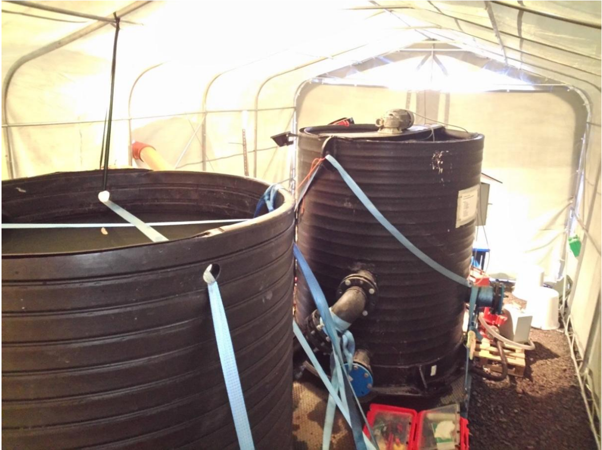
Kuva 6. Pystyselkeytin (vas.) ja hämmennysallas (oik.) toiminnassa koeajoissa.
