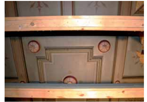
Kattopinnot yllättivät koristeellisuudellaan. Muutoin rakennus oli hyvin yksinkertaiseksi riisuttu
