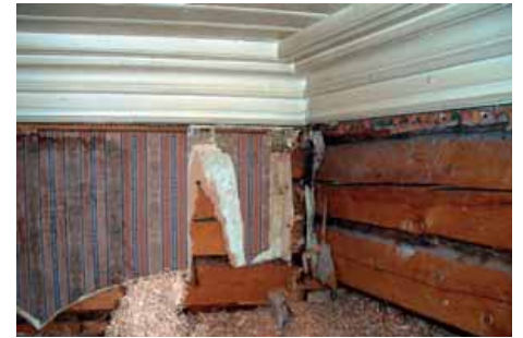
Onteloiden sisältä paljastui lisäksi alkuperäistä listoitusta, tapetti- ja kangasfragmenteja
