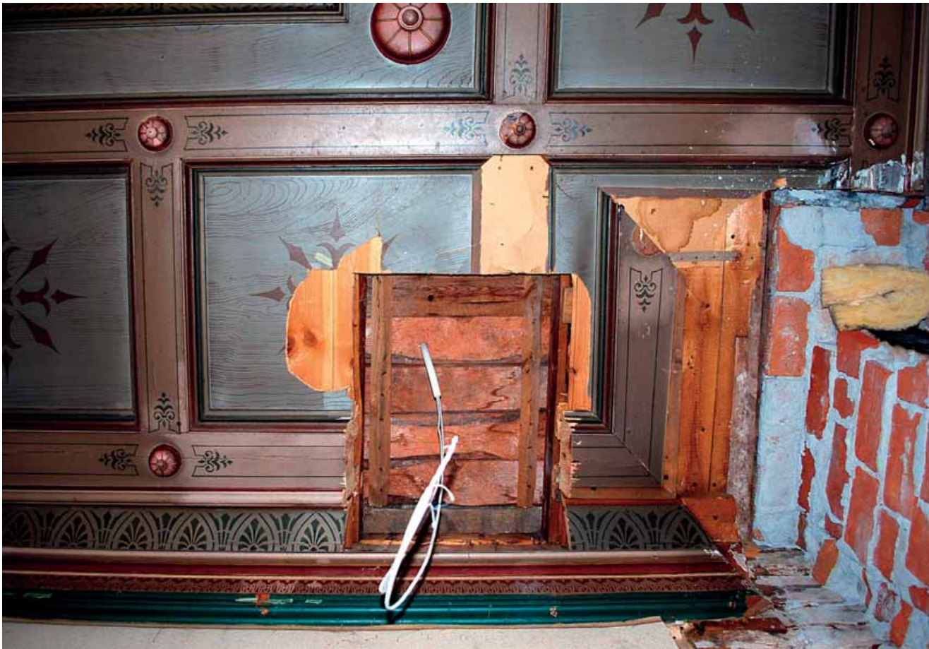
Kauniiseen kattopintaan sahattu tarkastusluukku. Muurin viereiset listat oli purettu ja hävitetty
