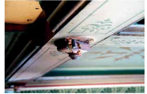
Keisarin salongin vaurioitunut kattorosetti
