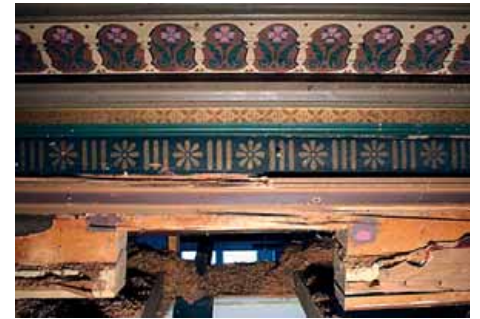
Muutostöiden aikana alkuperäisiin rakenteisiin ei kiinnitetty liemmin huomiota
