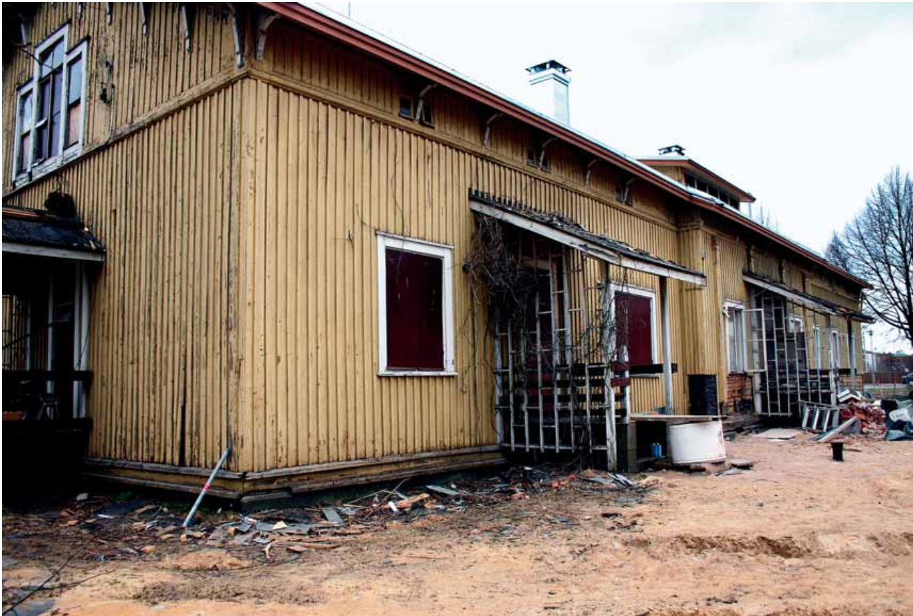
Vanha asemarakennus oli päässyt huonoon kuntoon. Muutostyöt ja tekemättömät huollot olivat muuttaneet ulkonököä radikaalisti
