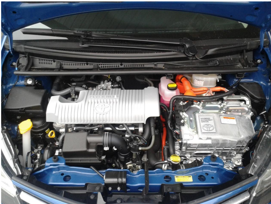
KUVA 24. Korkeajännitekaapelit ovat merkitty oranssilla suojakuorella
