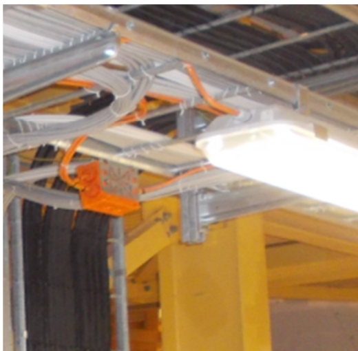
KUVA 11. Turvavalaistus, jossa kaapelointi ja kytkentärasia on palonkestävä.
