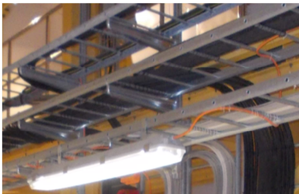
KUVA 13. Keskitetyn tehonsyötön turvalaisin on kytketty palonkestävään johtojärjestelmään.
