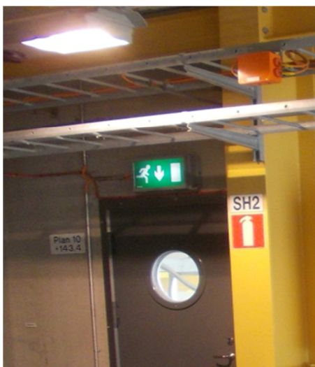
KUVA 15. Valaistus ja uloskäytäväkilpi.
