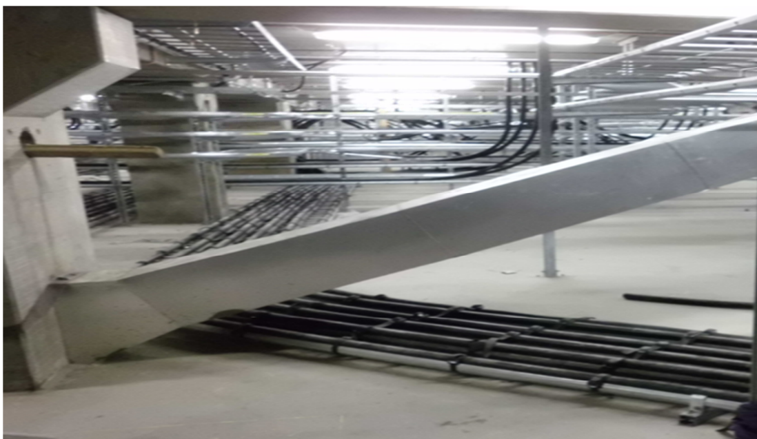
KUVA 8. Kaapelitilan hyllyreitit ja hyllytuennat.
