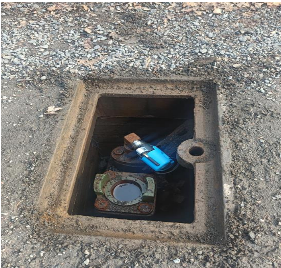
Kuva 6. Vuotoääniloggeri (Oma kuva, 2023)
