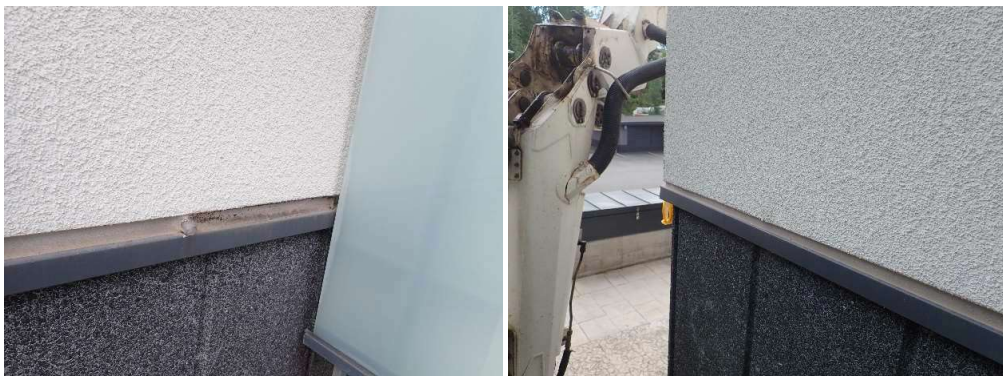
Kuva 50. Eristerapatun julkisivun ja 1. kerroksen sandwich-elementin liittymä on toteutettu elastisella saumalla, johon oli sijoitettu tuuletusputkia n. 1. metrin välein.
