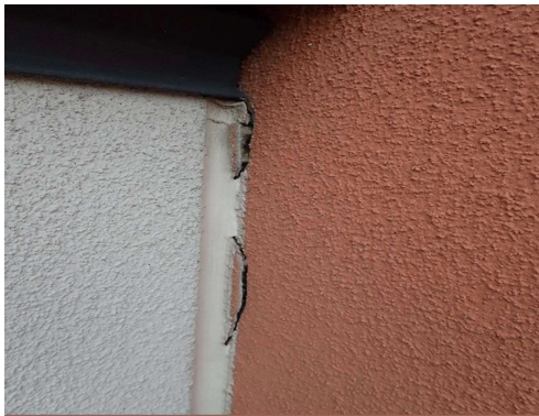
Kuvat 8 a, b ja c. Kuvat A- ja C-talojen välisistä liittymistä. Kuvat a ja b: Suojapeltien ja julkisivun välinen saumaus tekemättä. Kuva c: Vaurioita elementtien välisessä saumassa/ rappauksessa.
