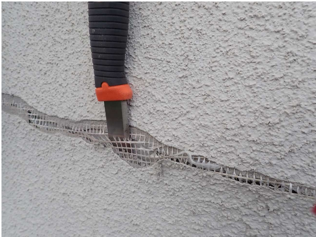
Kuva 15. Kuvassa näkyvässä rappausverkon osittainen repeäminen, joka on aiheuttanut leveän vaakasuuntaisen halkeaman. (Vahanen Rakennusfysiikka Oy 2022)
