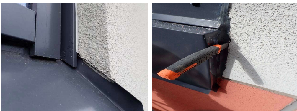
Kuvat 33 a ja b. Kuvissa C- ja D-talojen itäjulkisivussa havaittuja puutteita ikkuna- ja peltiliittymien tiivistyksissä / saumauksissa.
