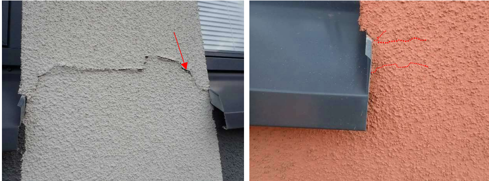
Kuvat 5 a ja b. Kuvissa halkeamavaurioita ikkunoiden välisellä kapealla julkisivun osalla sekä liittymien läheisyydessä. Kuvassa a, pintarappaus irti, eri laastikerrosten välinen tartunta heikko ja paikoin rappausverkkoon näkyvissä (kuvat A-talosta). Kuva b: tavanomainen vaurio ikkunanurkassa.
