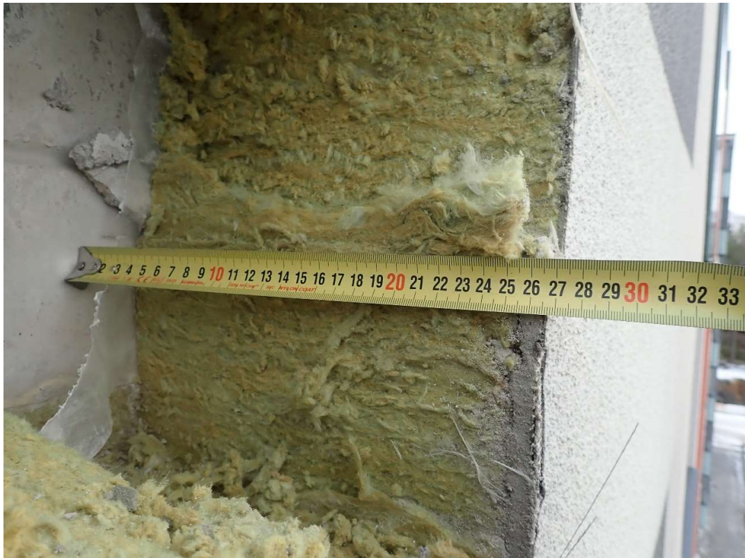
Kuva 4. Kuvassa elementtien vaakasaumaan tehty rakenneavaus rakenteen selvittämiseksi. Kuvassa havaittavissa mm muovikalvo eristeen takana, huomattavan paksu rappauskerros alemman elementin vaakasauman kohdalla. (AFRY Buildings Finland Oy 2023)
