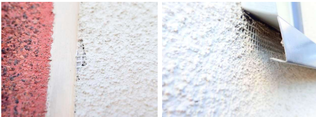
Kuvat 6 a ja b. Kuvat A-talon idän puoleisesta julkisivusta. Kuva a: julkisivun ja parvekelinjan välisestä liittymästä, pintarappaus irronnut, kulma joustaa. Kuva b: vesipellin alapuolelta puuttuu pintarappaus.
