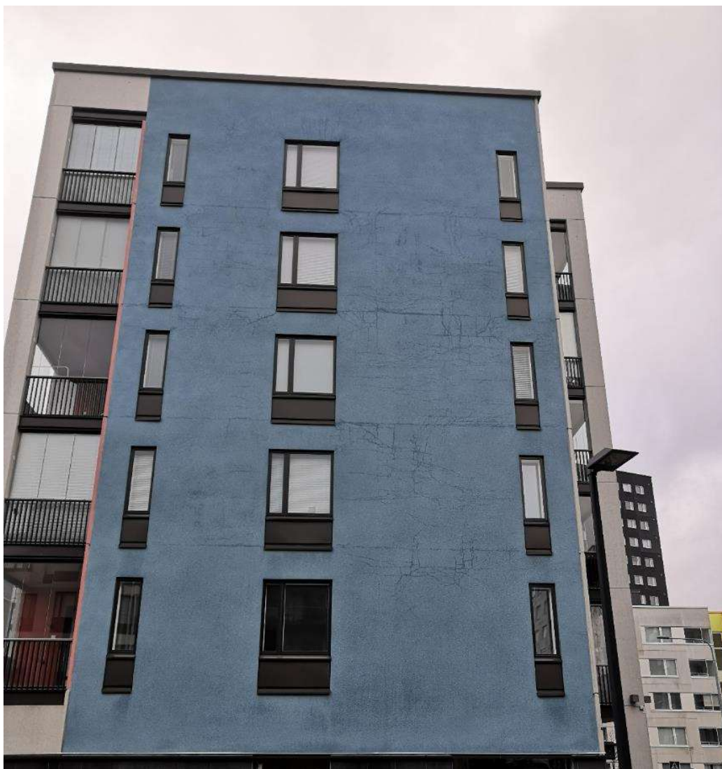
Kuva 13. Sateen jälkeen tummiksi rapatuissa julkisivussa olevat halkeamat ovat helposti havaittavissa. (Vahanen Rakennusfysiikka Oy 2021)
