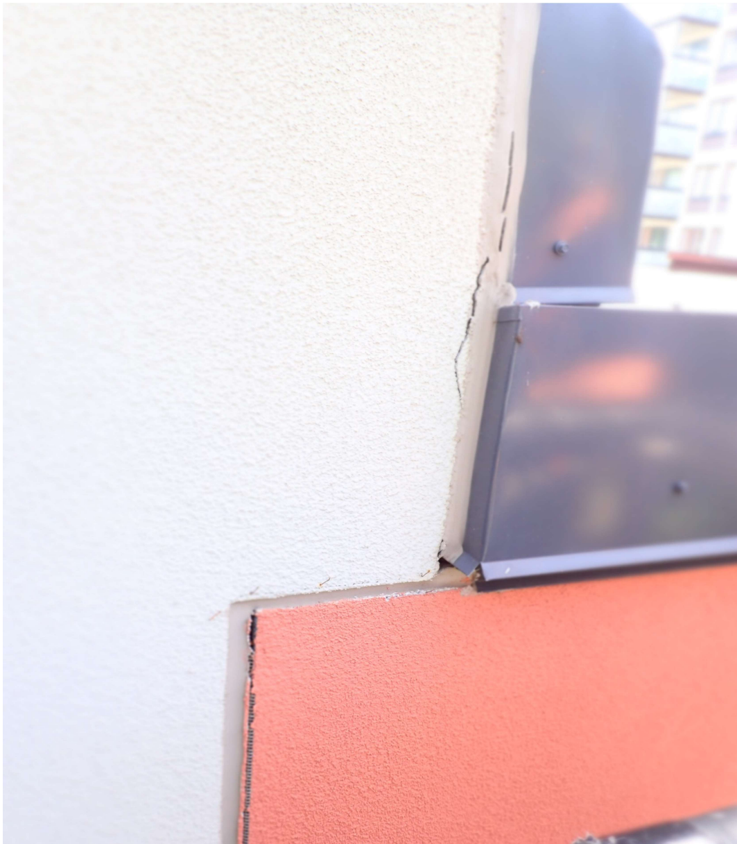
Kuva 23. Kuvassa liittymien ja liikuntasaumojen toteutuksissa havaittuja puutteita. (Vahanen Rakennusfysiikka Oy 2022)
