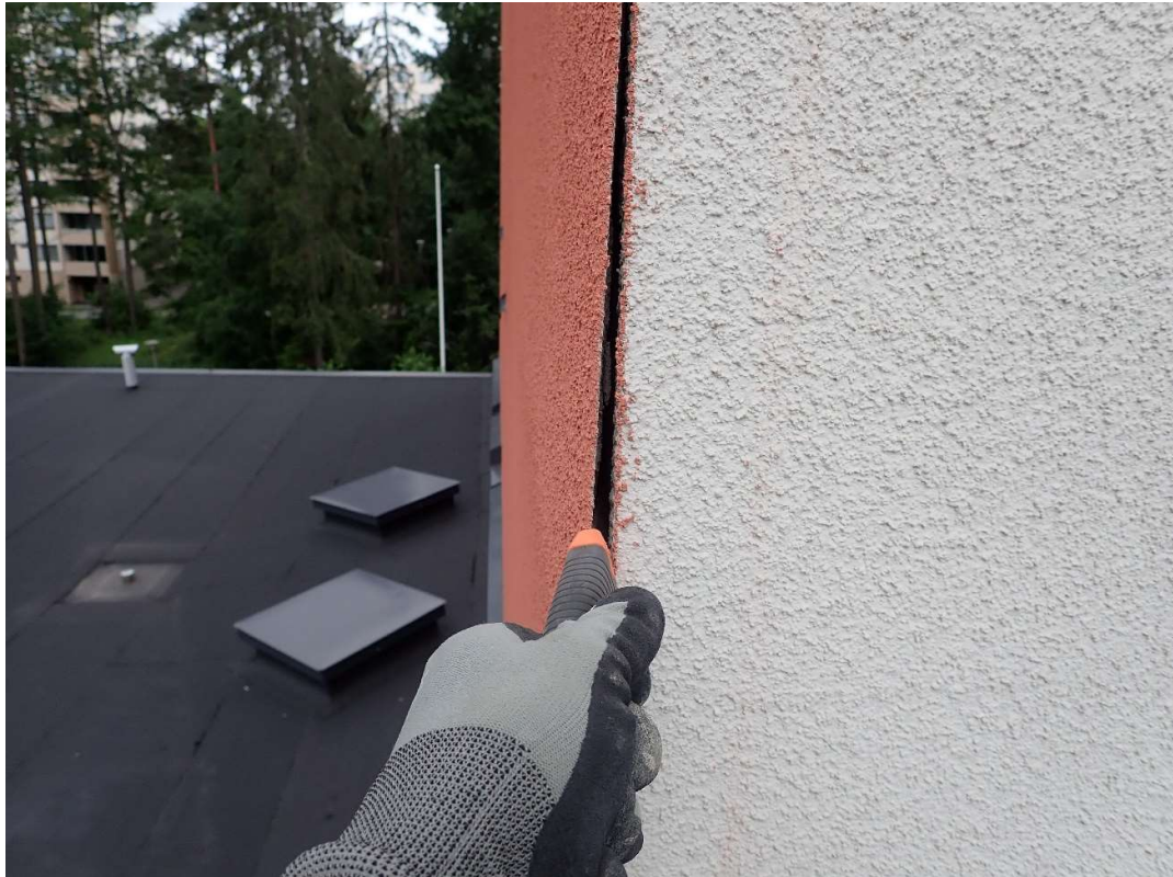
Kuva 22. Kuvassa julkisivujen kulmassa havaittu työnaikainen asennusvirhe. Kulma-alueen rappausverkkojen limitys puutteellinen. (Vahanen Rakennusfyysikka Oy 2022)
