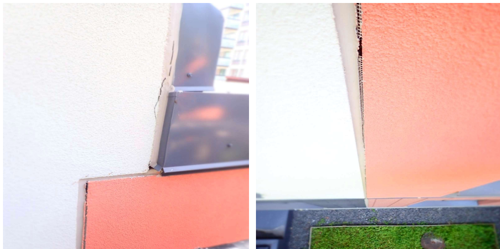
Kuvat 31 a ja b. Kuvissa D- ja C- talojen välinen liittymä talojen länsisivulta. Saumaus irronnut alustastaan pitkältä matkalta. Liittymän kohdalla on rappausverkko näkyvässä ja pintarappaus irronnut.
