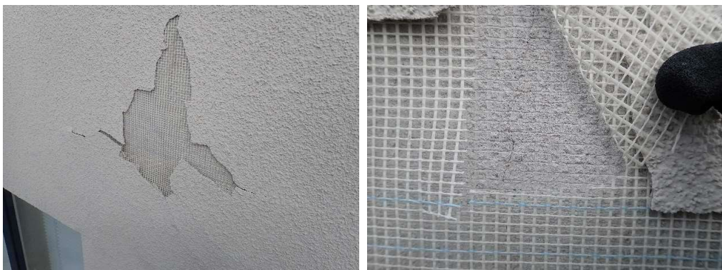
Kuvat 16 a ja b. Pintalaasti on lohkeillut irti monin paikoin. Kuvissa verkotus- ja suojalaastissa on havaittavissa halkeama. Verkotus- ja suojalaasti on hyvin haurasta ja rappausverkko on irti verkotuslaastista.
