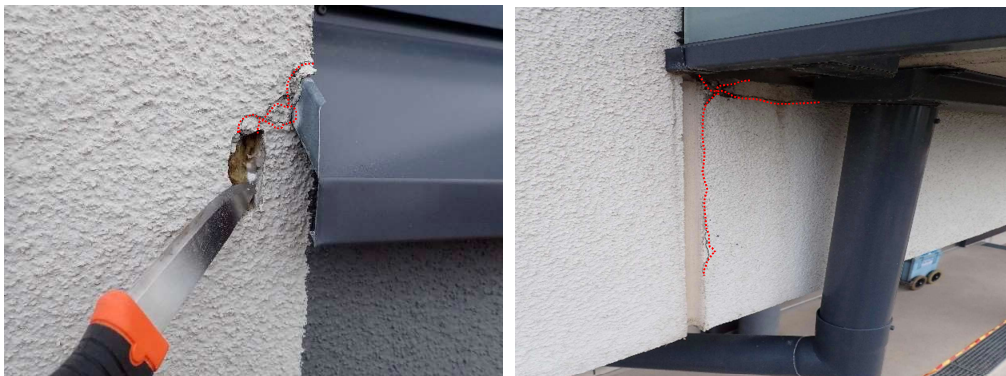
Kuvat 9 a ja b. Kuvissa A-talossa havaittuja liittymävaurioita. Vesipellin- ja julkisivun liittymässä halkeama eristekerrokseen asti. Parvekelaatan ja julkisivun liittymässä sekä elementin sauman vieressä halkeama (merkitty punaisella katkoviivalla).
