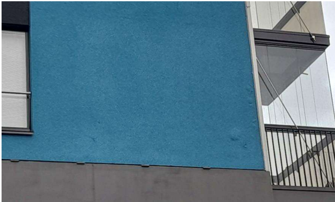
Kuva 20. Pinnoitteessa näkyvää kuplimista. (Vahanen Rakennusfysiikka Oy 2022)
