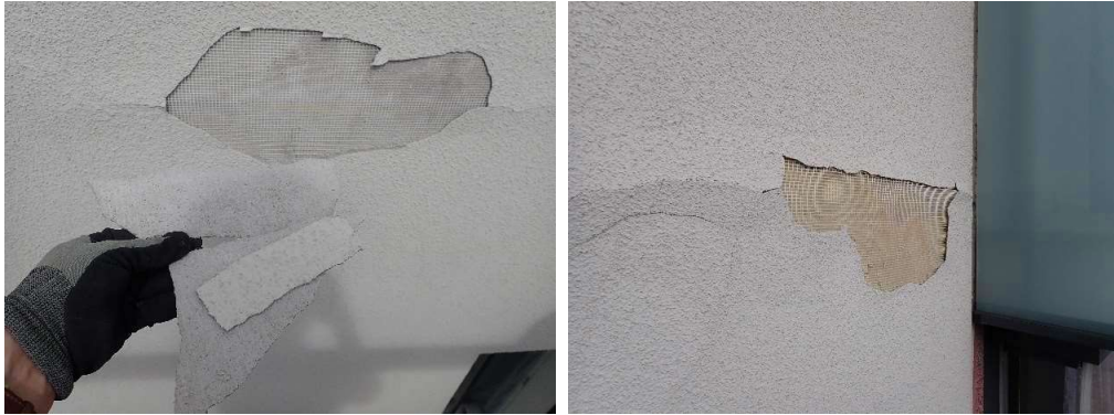
Kuvat 22 a ja b. Pintarappaus irtoaa halkeamien läheisyydessä suurina paloina. Rappausverkossa/verkotuslaastissa havaittavissa kosteuden aiheuttamia värimuutoksia. Rappauskerrosten välinen tartunta heikko.
