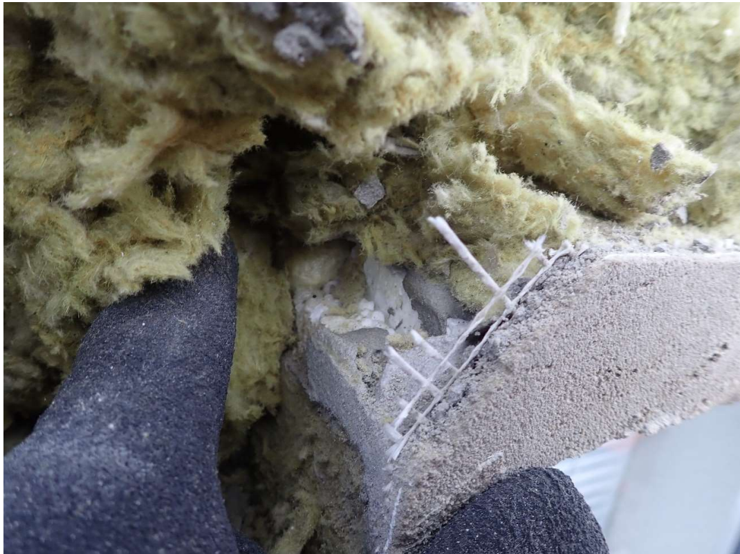
Kuva 25. Kuvassa laastilla ja EPS- eristeen suikaleilla täytettyjä lamellivillaeriste kerroksessa olleita koloja. (Vahanan Rakennusfysiikka Oy 2022)
