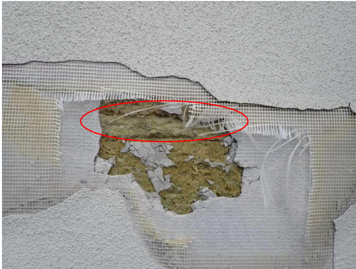
Kuva 23. Kuvassa rakenneavaus julkisivussa havaitusta vauriokohdasta. Kuvassa nähtävissä elementtien välinen sauma (merkitty punaisella), joka on toteutettu mineraalivillalla. Pintarappaus irtoaa suurina palasina ja rappausverkko on irti sekä pinta-että verkotuslaastista. Verkotus- ja suojalaasti on rapautunutta / haurasta.
