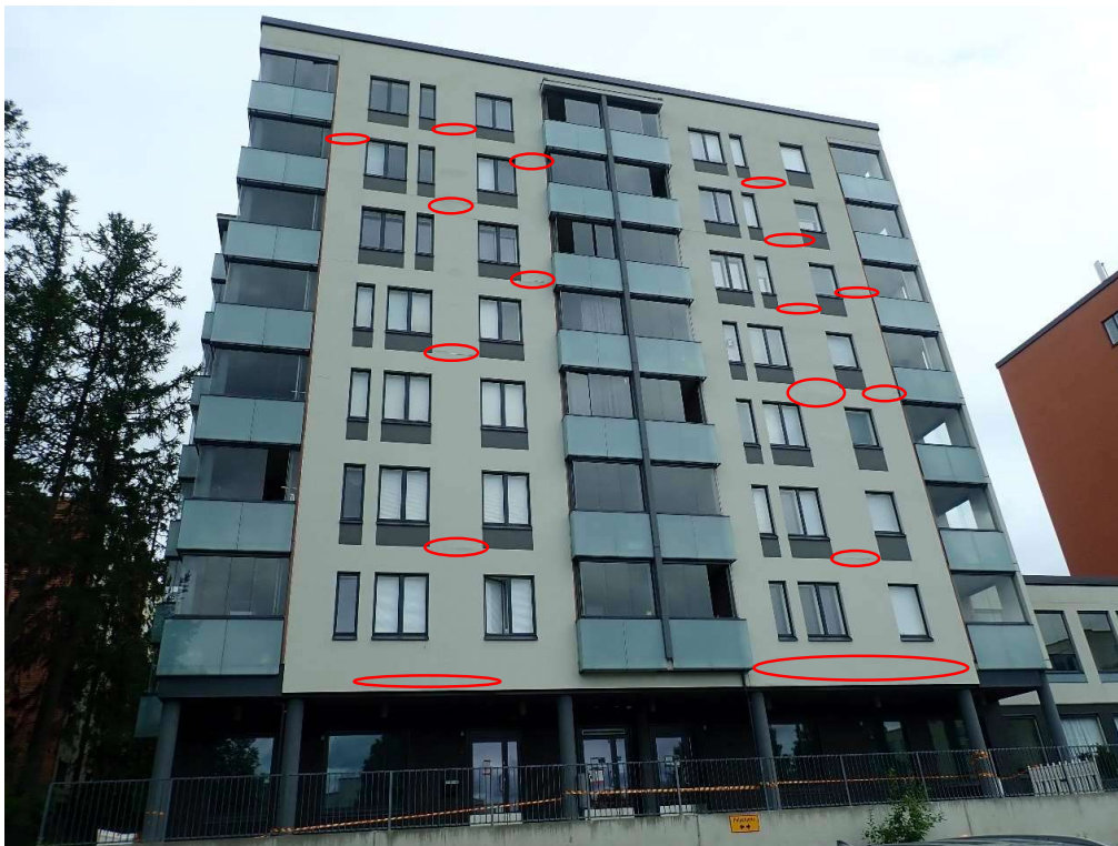
Kuva 14. Yleiskuva B-talon etelän puolen julkisivusta. Kuvaan merkitty punaisella alueille, joilta rappaus on selvästi irti alustastaan, putoamassa tai jo pudonnut.
