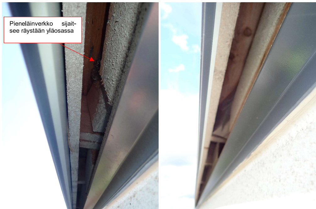
Kuva 49. Yleiskuvat räystäältä. Räystäspeltti ei ulotu riittävän pitkälle ja paikoin tuuletusrako on hyvin leveä (yli 5 cm), jolloin tuiskulumi voi kulkeutua rakenteisiin.
