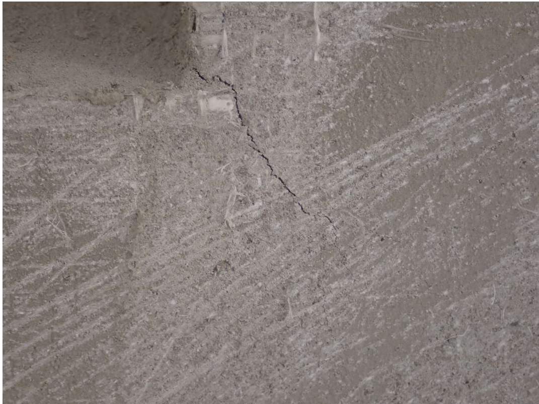
Kuva 26. Kuvassa puutteellisesta jälkihoidosta aiheutunutta verkotuslaastikerroksen halkeilua ikkuna-aukon kulmassa. (AFRY Buildings Finland Oy 2023)
