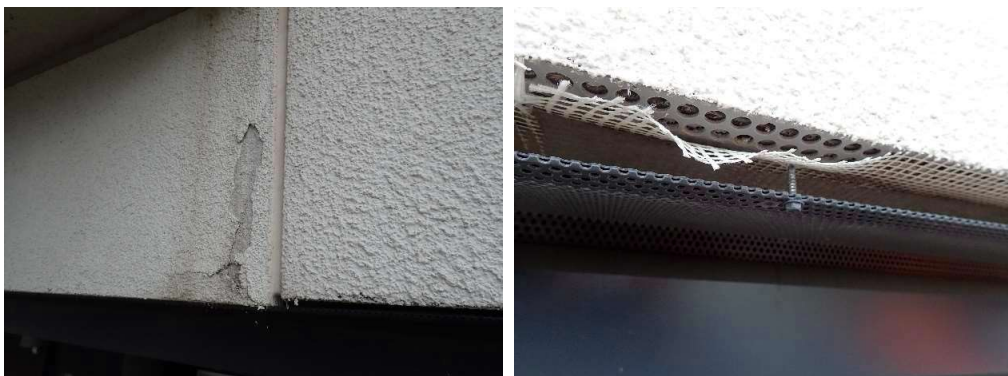
Kuvat 7 a ja b. Kuvassa a pintarappaus irronnut pohjalaastista. Kuvassa b ulkoseinän alaosan liittymä, ns. sokkeliprofiili. Liittymän alareuna rappaamatta, rappausverkko revennyt ja alareunan tuuletusritilä irronnut.
