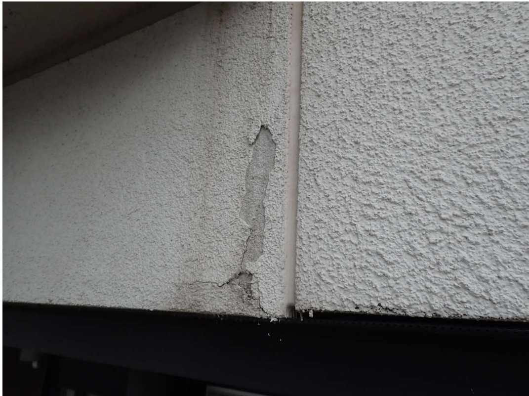
Kuva 18. kuvassa pakkasrapauman aiheuttama vaurio elementin alaosassa. (Vahanan Rakennusfysiikka Oy 2022)
