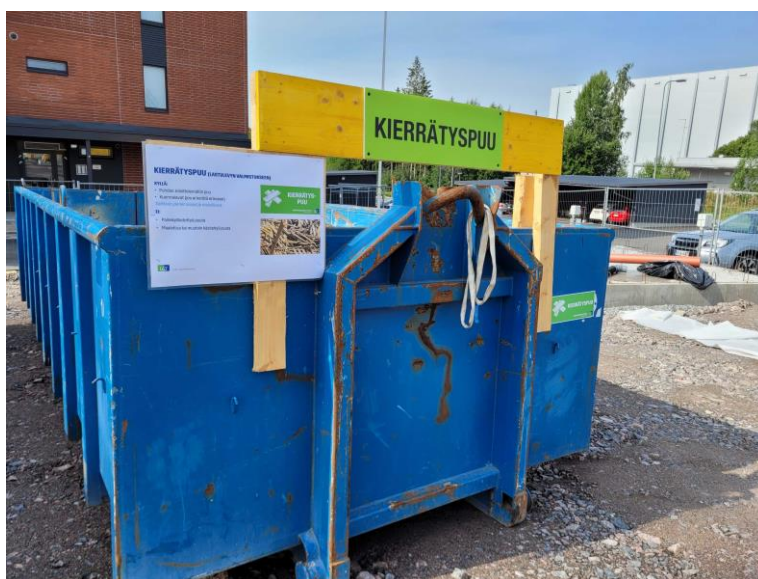
Kuva 5. Kierrätyspuulle tarkoitettu vaihtolava. (YIT Suomi Oy:n sisäinen 2023)
