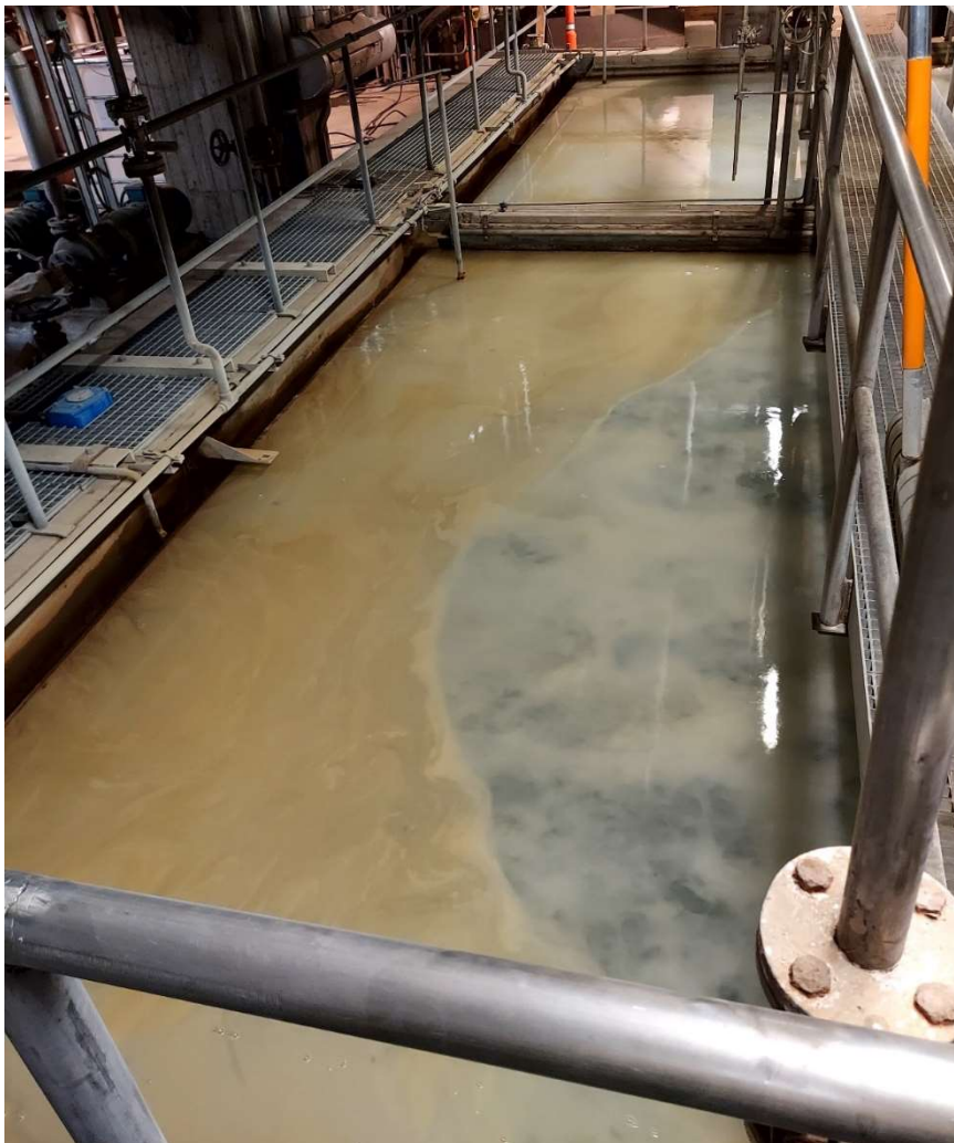
Kuva 8. Aittaluodon voimalaitoksen flotaatioaltaat. Pinnalla näkyy ylijuuksulla poistettavat epäpuhtaudet. Vaaleammat kohdat pinnalla ovat ilmakuplia.
