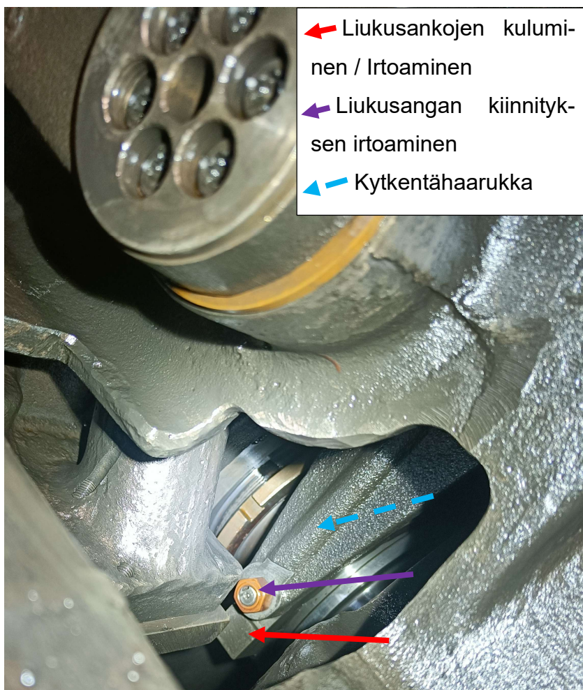
KUVA 39. Kytkenähaarukan vikakohteita (Kuva: Juuso Puranen)
