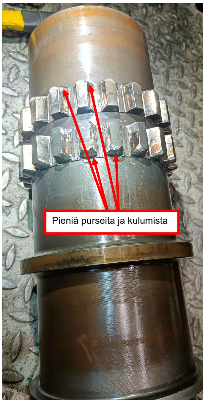
KUVA 64. Kytkentäholkki irrotettuna (Kuva: Juuso Puranen)
