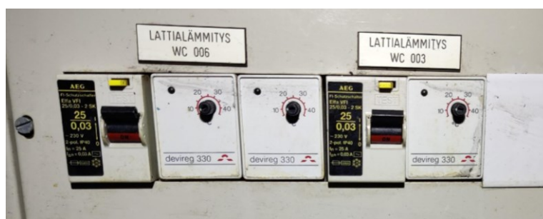
Figur 12. Termostat och Jordfelsbrytare för golvvärme
