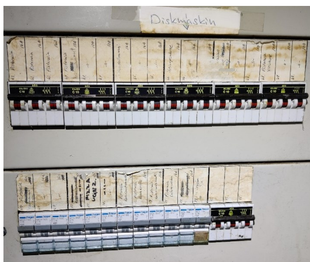
Figur 4. Säkringar i den gamla centralen.
