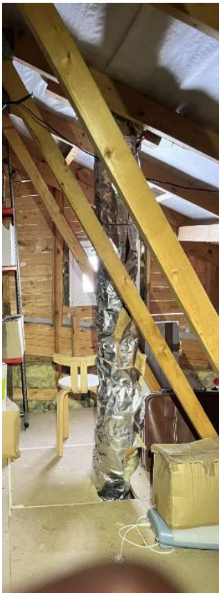
Kuva 26. Poistoilmakanava ullakolla (Entavision Oy 2024).
