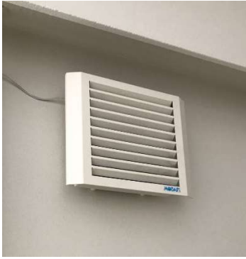
KUVA 24. Puhallintoiminen Mobair-seinäventtiili. (Entavision Oy 2024).
