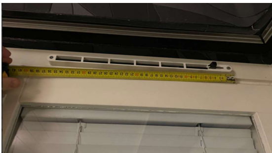
KUVA 23. Makuuhuoneissa ja keittiössä oli rakoverventtiilit Fresh F31 (Entavision Oy 2024).
