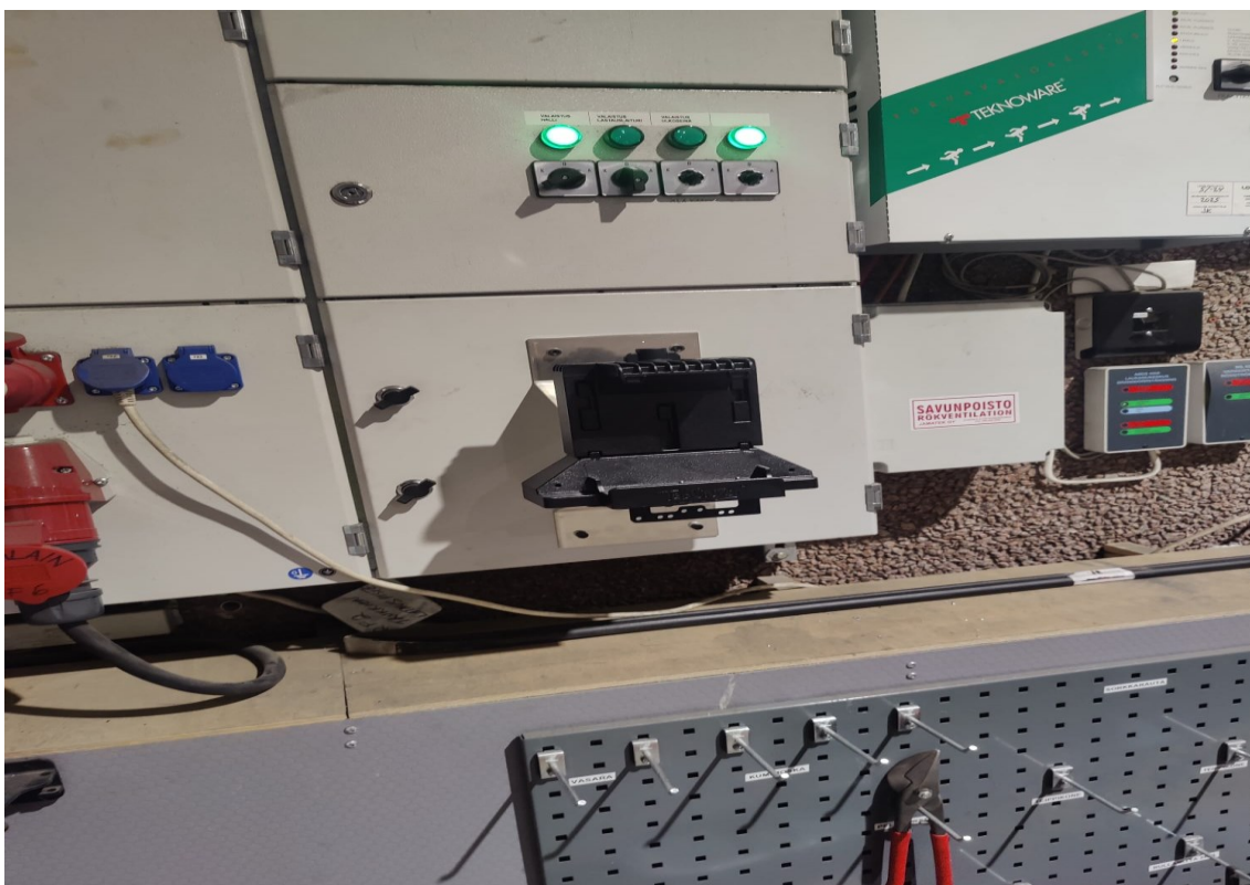
Kuva 4. Tyhjä tablettitelakka asennettuna.
