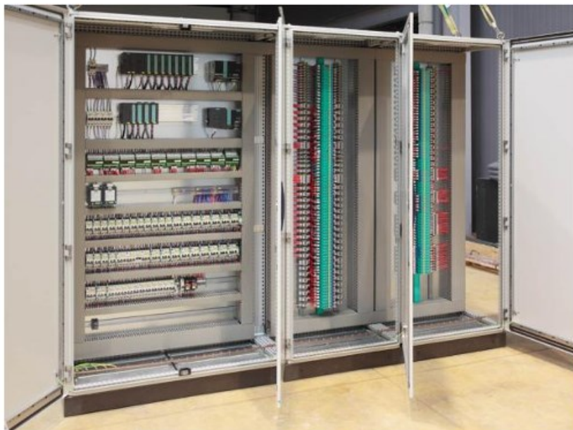
Figur 23: En bild på typiskt innehåll i en elcentral i en industri. (Industrial Control Panels and Electrical Equipment of Industrial Machinery for North America, 2014).
