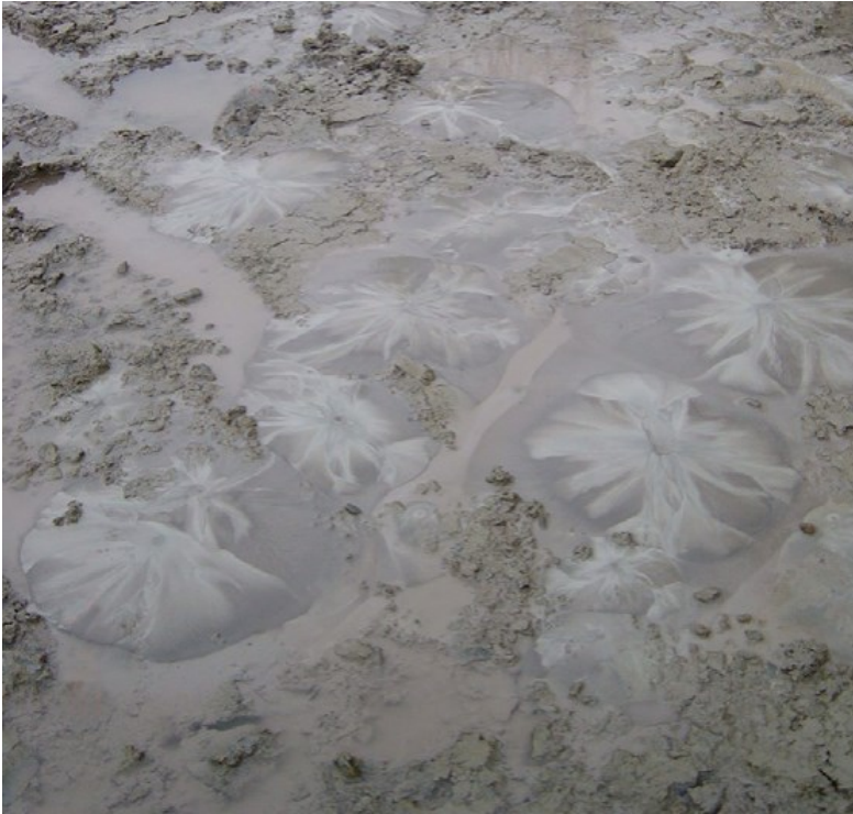
Figur 1 Schaktbotten vars bärighet försämrades betydligt då man inte hade kontroll på grundvattenflödet under schakten (Lundström, Odén, & Rankka, 2015).
