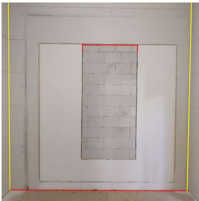
Kuva 13. Testausseinässä havaitut vuotokohdat.
