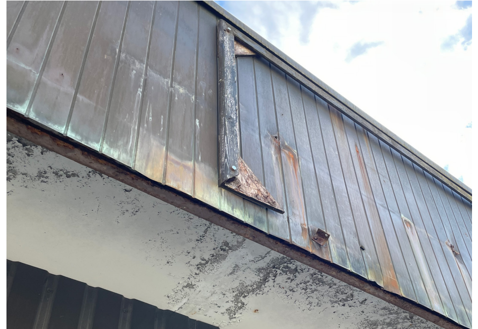
Kuva 23: Sisäpihan liikerakennukset ovat päässeet huonoon kuntoon
