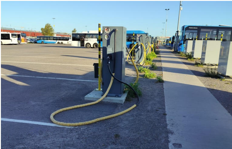
Kuva 18. Latauskaapeli maapinnalla (Künnap J, 2023).
