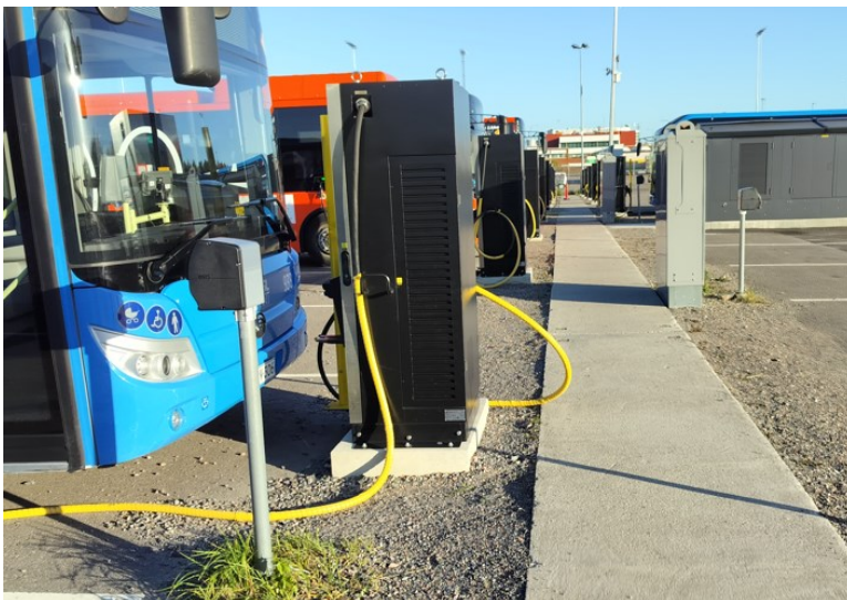
Kuva 19. Latauskaapeli osittain kävelyväylällä (Künnap J, 2023).
