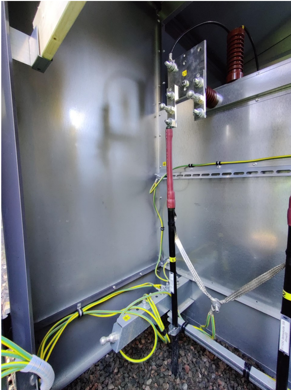
Kuva 8. Keskijännitetilän 20 kilovoltin maakaapelin avopääte ja sen maadoitusjohtimet.
