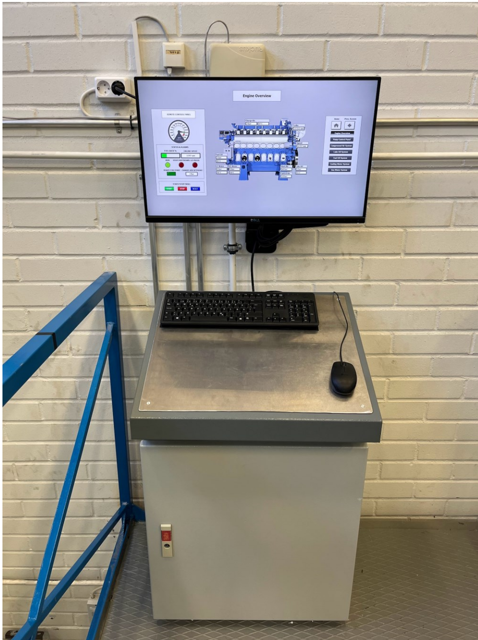
Figur 7. Fjärrkontrollskåp med tillhörande övervakningsskärm.
