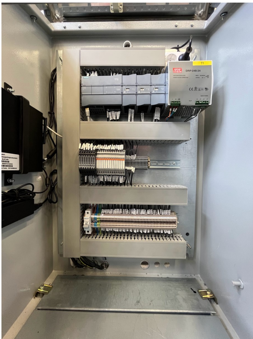
Figur 8. PLC med kringliggande komponenter.
