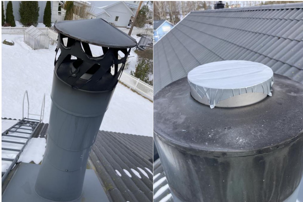
Kuva 10. Savupiippu teipattu umpeen ilmastointiteipillä.
