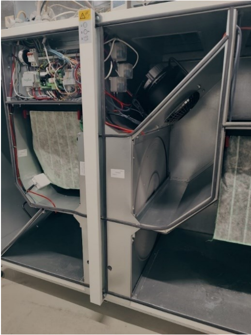
Kuva 5. IV-pakettikone pyörivällä lämmöntalteenotolla
