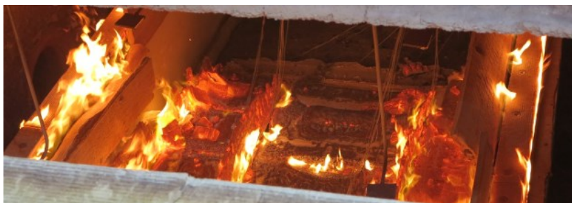
Kuva 21. Rakenne palotestauksen lopetuksen jälkeen.
