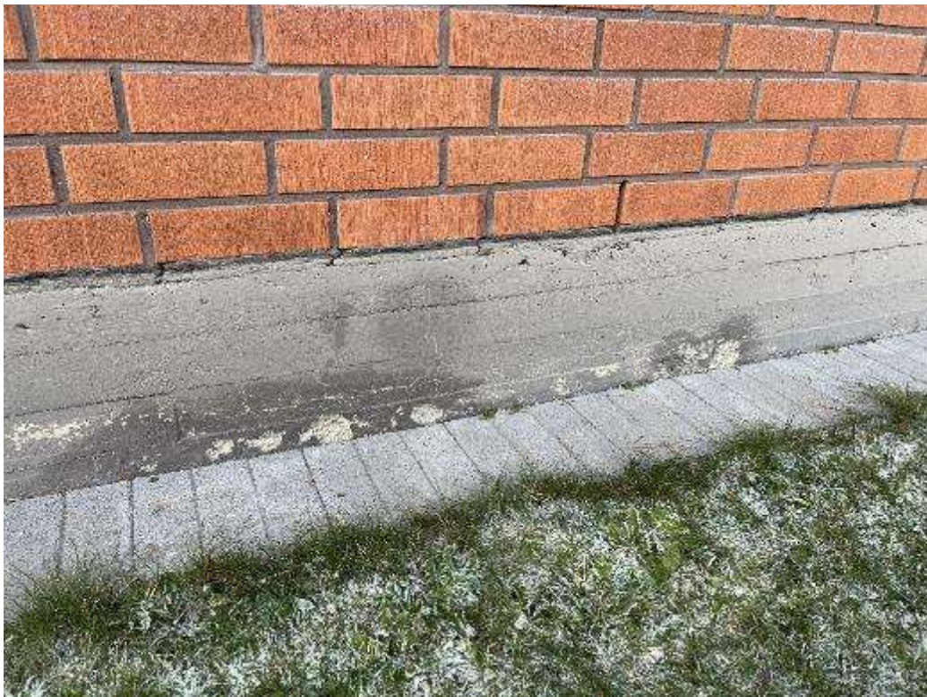
Kuvio 4. Pinnoitteen vaurioita sokkelissa
