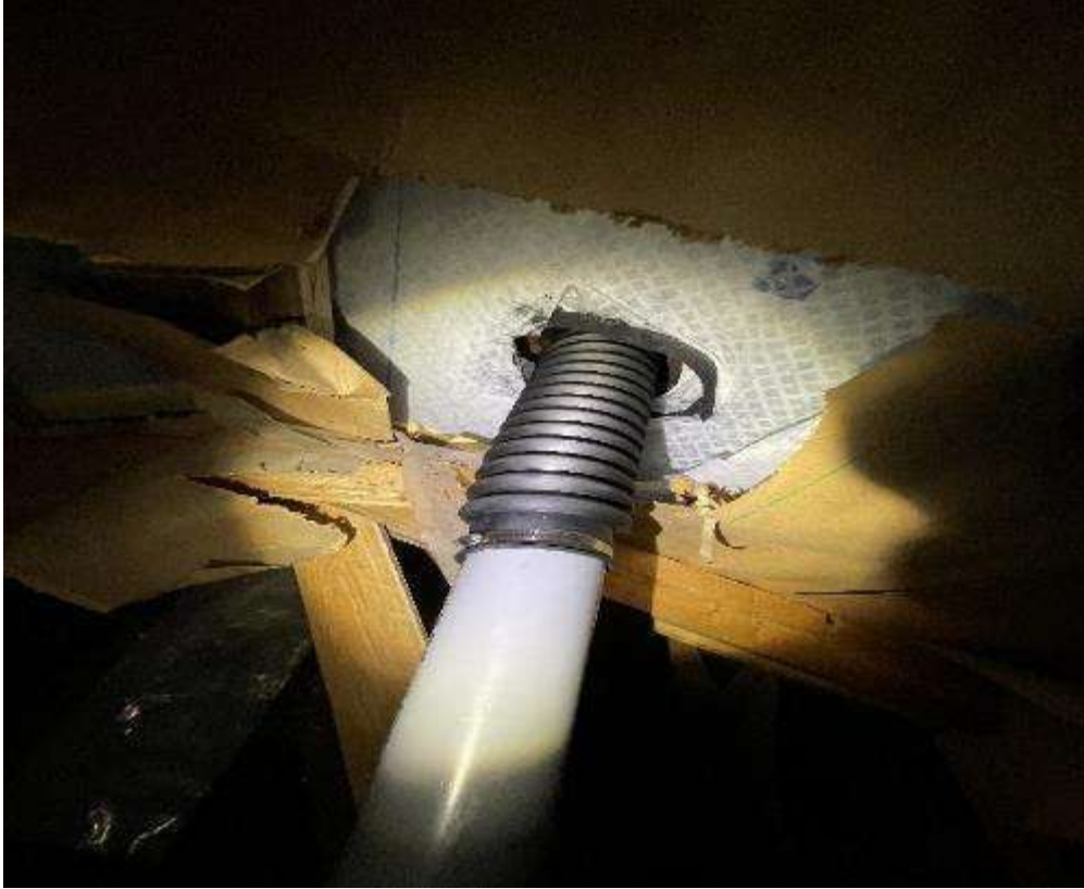
Kuvio 19. Viemärin tuuletusputki
