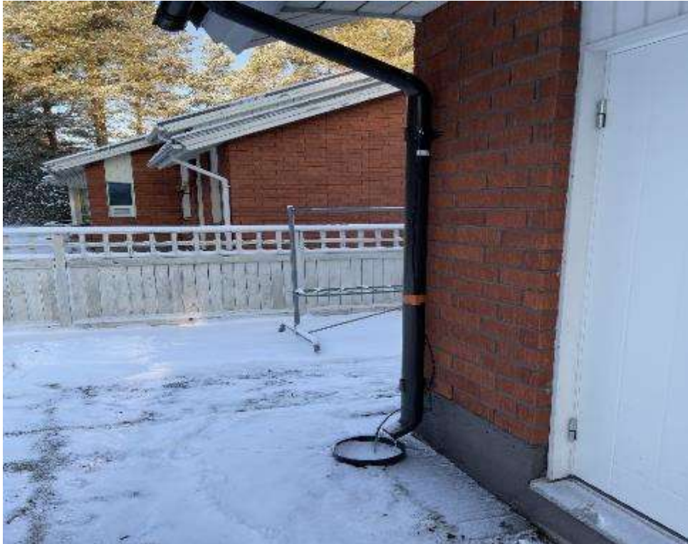
Kuvio 6. Sadevesikaivon lämmityskaapeli
