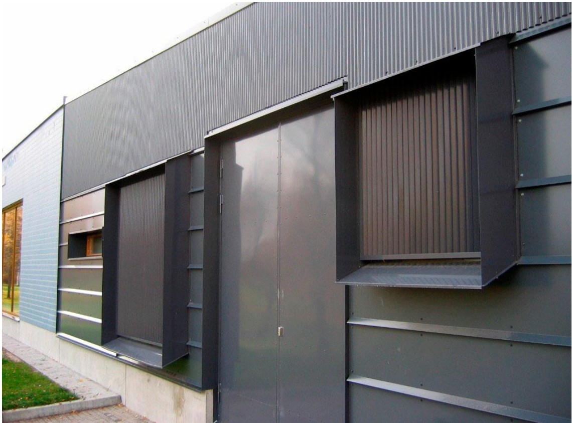
Kuva 19. Sää-/lumisuoja rakennuksen seinässä (Stravent-sääsuoja – seinän ulkopintaan asennettava alumiinisääsuoja).
