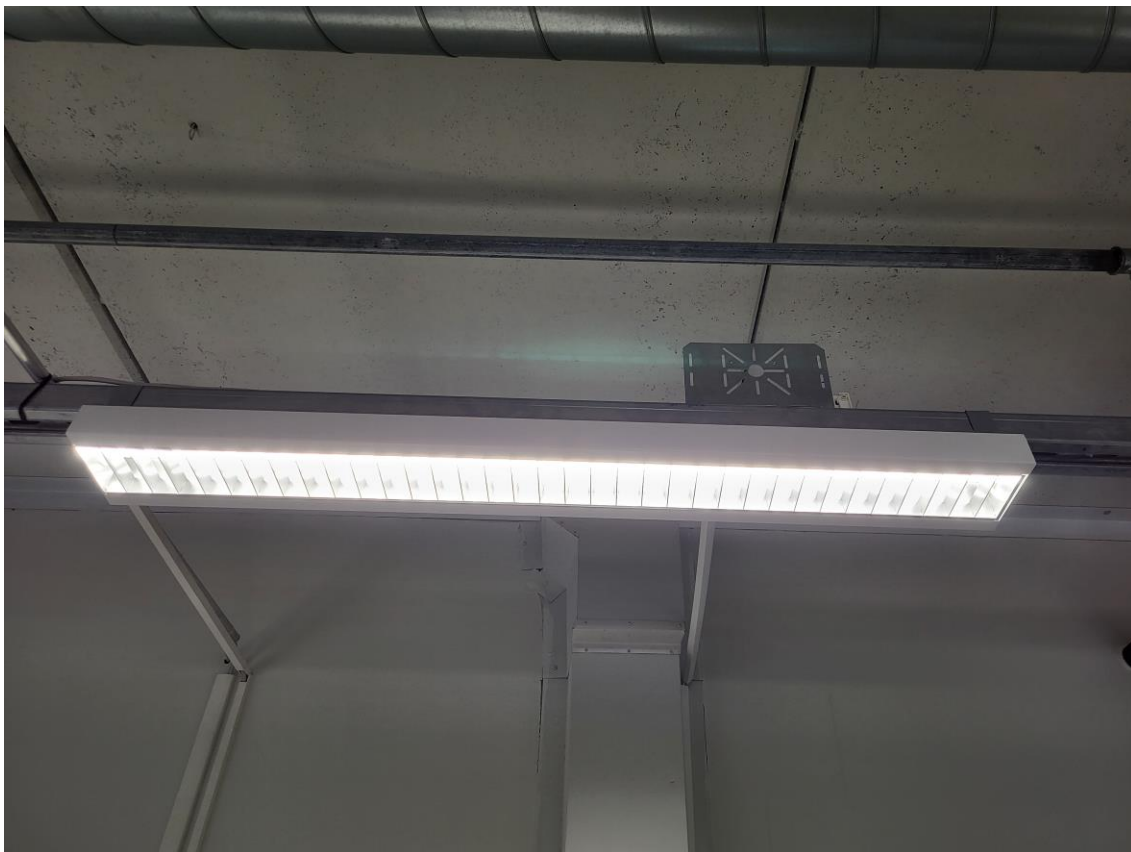
Kuva 21. Led valaisin kiskoasennuksena.
