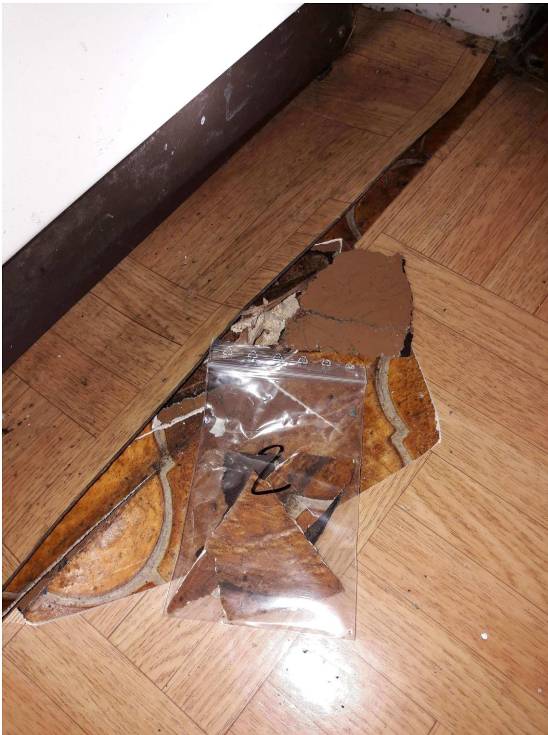
Kuva 6. Uudempien muovimattojen alla vanha asbestipitoinen muovimatto. (Galleria (asbesti) osa 3.)
