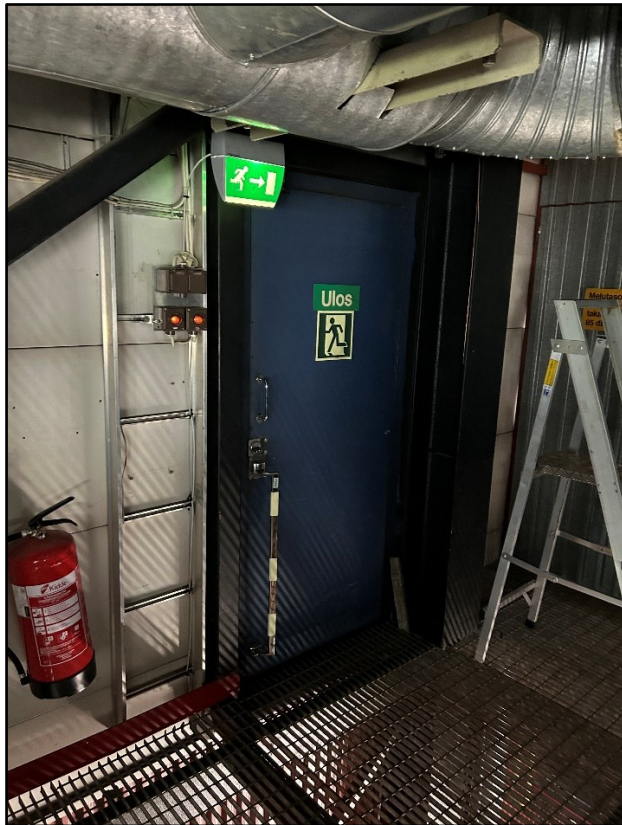
Kuva 8. Koivukylän lämpökeskuksen opastevalaisin. Koivukylän Lämpökeskuksella sijaitsevat opastinvalaisimet ovat hyvässä kunnossa.
