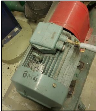
Kuva 19. Vanhan A-puolen paineenpitopumppu 6M4, joka tullaan poistamaan käytöstä. Käytöstä poistetaan myös paineenpitopumppua 6M3.
