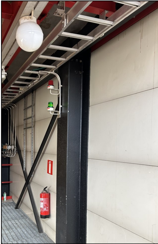
Kuva 7. Pyöreä valkoinen turvalo Koivukylän lämpökeskuksen kattilahallissa. Metallisessa palkissa näkyvät kaasuhälytysliikennevalot.
