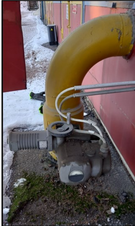
Kuva 24. Maakaasunpääsulku. Venttiiliä ohjaa aumaventtiili, jota voidaan ohjata etäyhteydellä.
