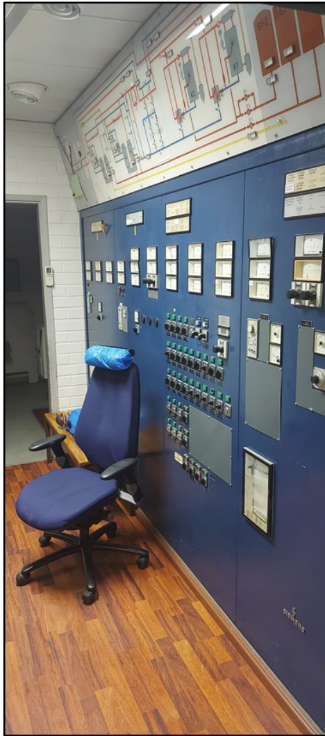
Kuva 20. Valvomon vanha laitostaulu.
