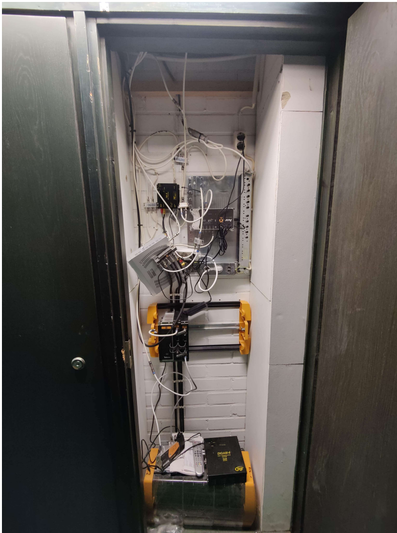
Kuva 17. Olemassa olevan antennijärjestelmän laitteet. (Hakala 2024)
