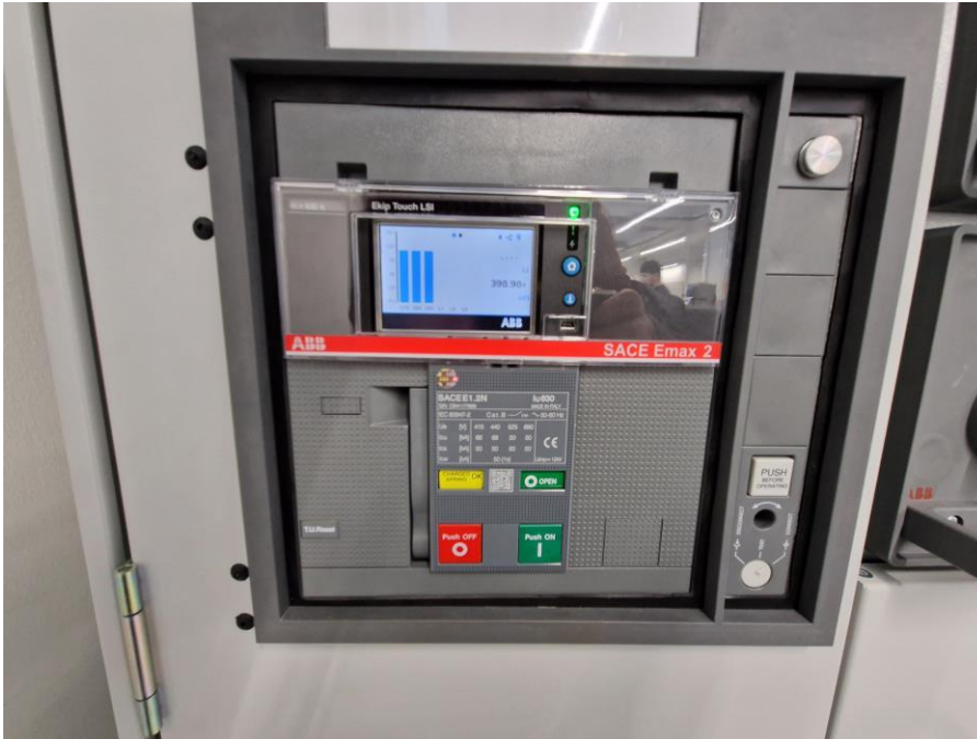
KUVA 8. Keskuksen pääkatkaisija ABB SACE Emax 2.
