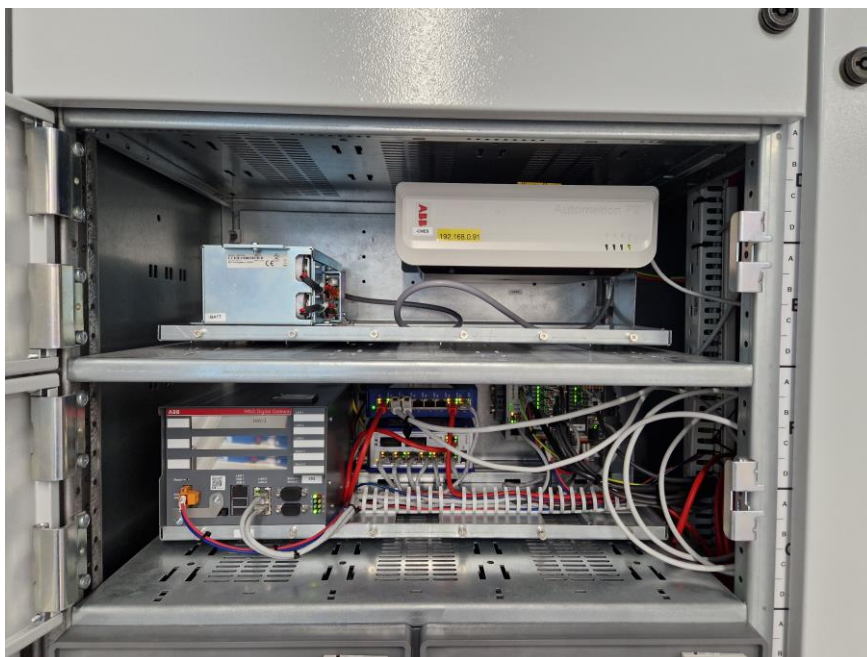
KUVA 15. Keskuksen automaatio- ja väylälaitteisto.
