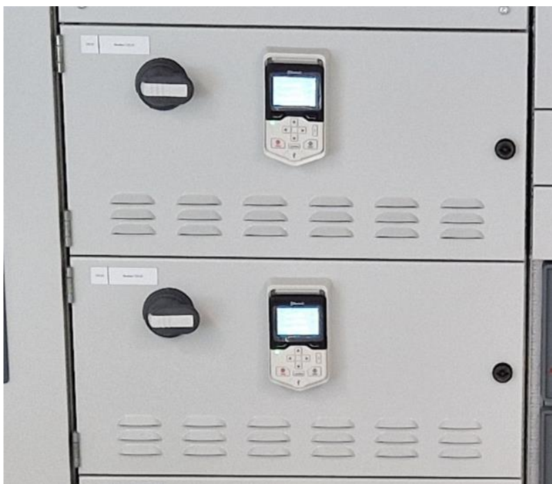
KUVA 13. ABB MNS Digital -keskuksen taajuusmuuttajalähtöjä.
