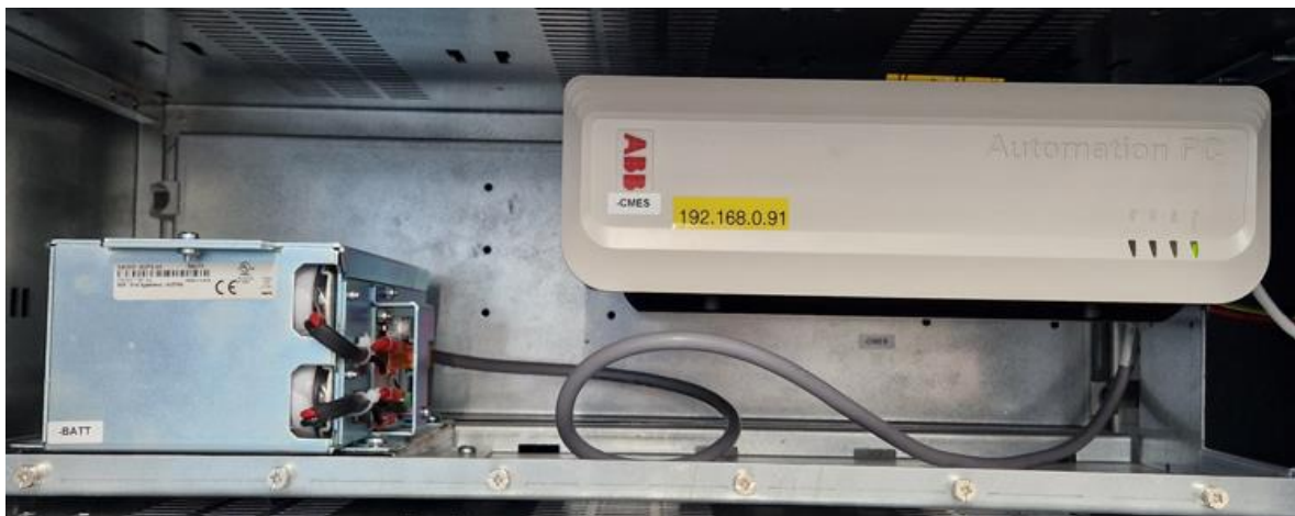
KUVA 17. CMES Edge -tietokone ja UPS-akku.
