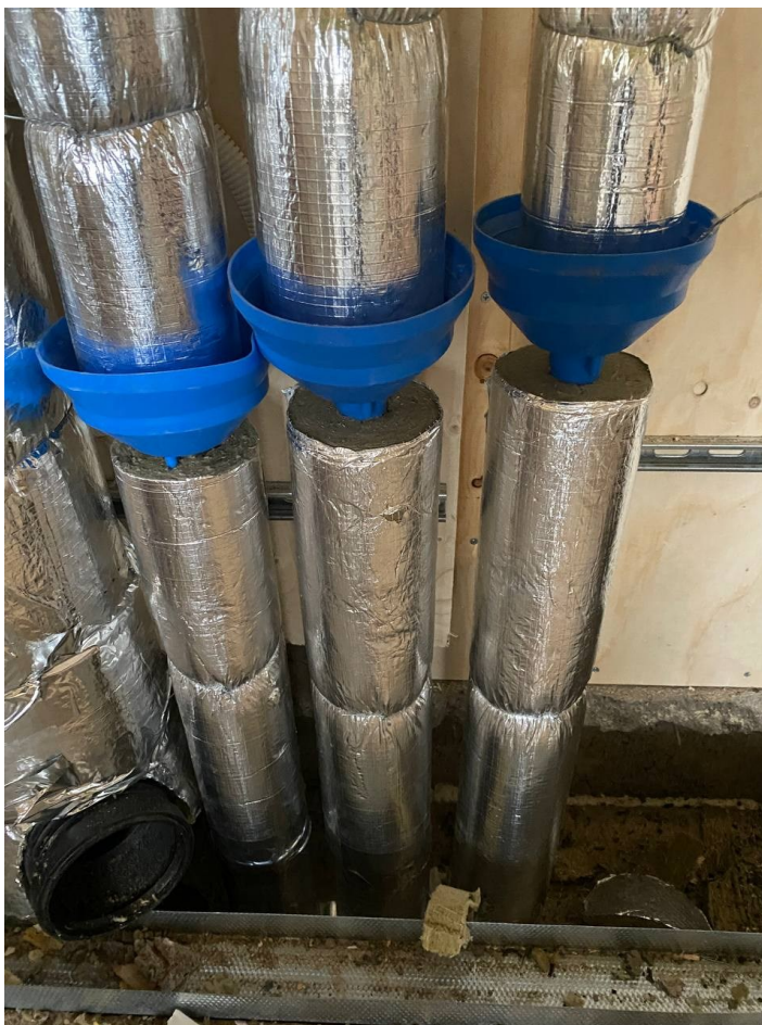
Kuva 2. Vuodonilmaisimet (kuvassa siniset muoviosat) työmaalla asennettuina.
