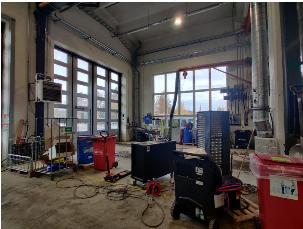
Kuva 5. Korjaamon lattialla oleva avonainen sähköjohto.
