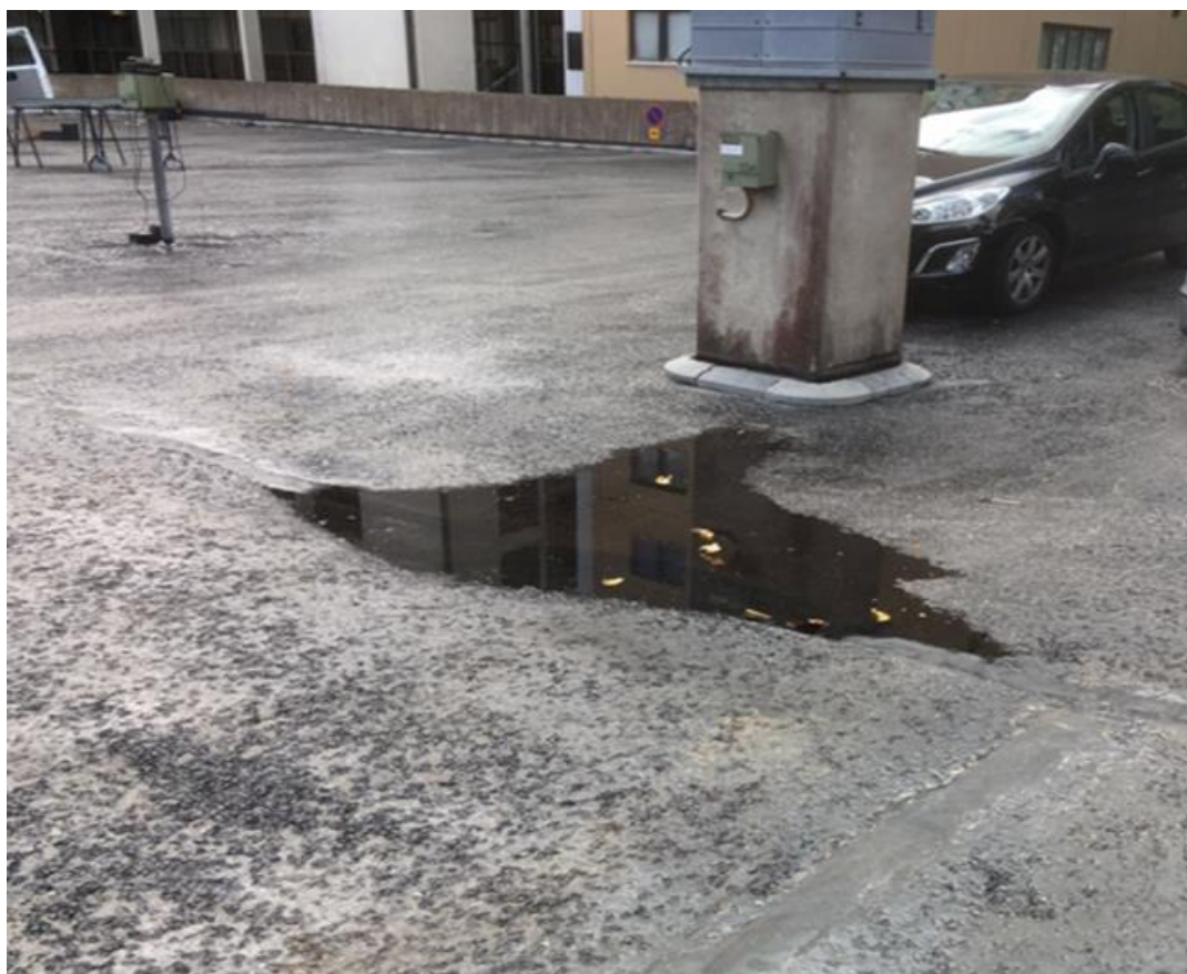
Kuva 12 Lammikko valuasfaltti päällysteessä, Riku Jansson 2023
