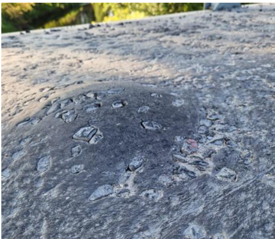
Kuva 10 Kosteuden aiheuttama kupla valuasfaltti päällysteessä, Riku Jansson 2023
