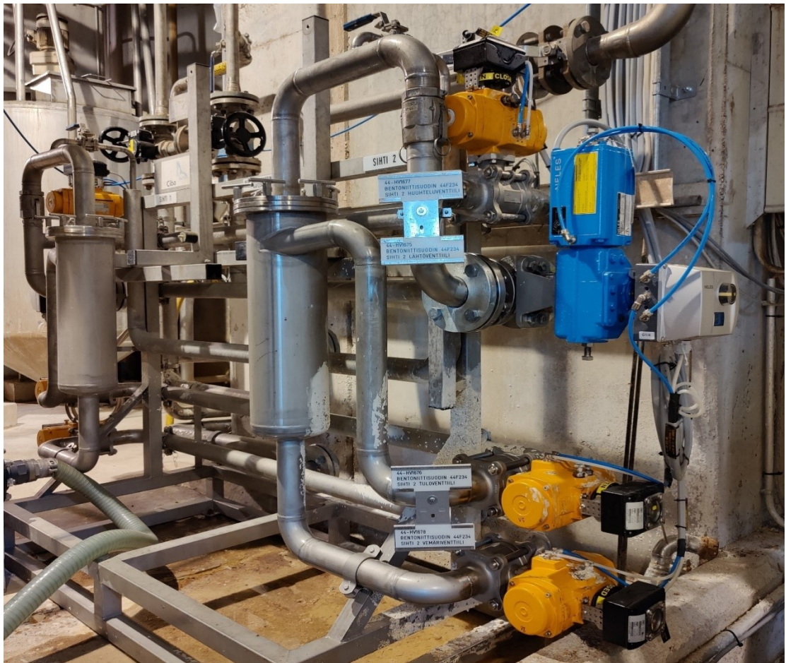
Kuva 25. Bentonitiin suodinlaitteisto asennuksien jälkeen (Hirvonen 2022)
