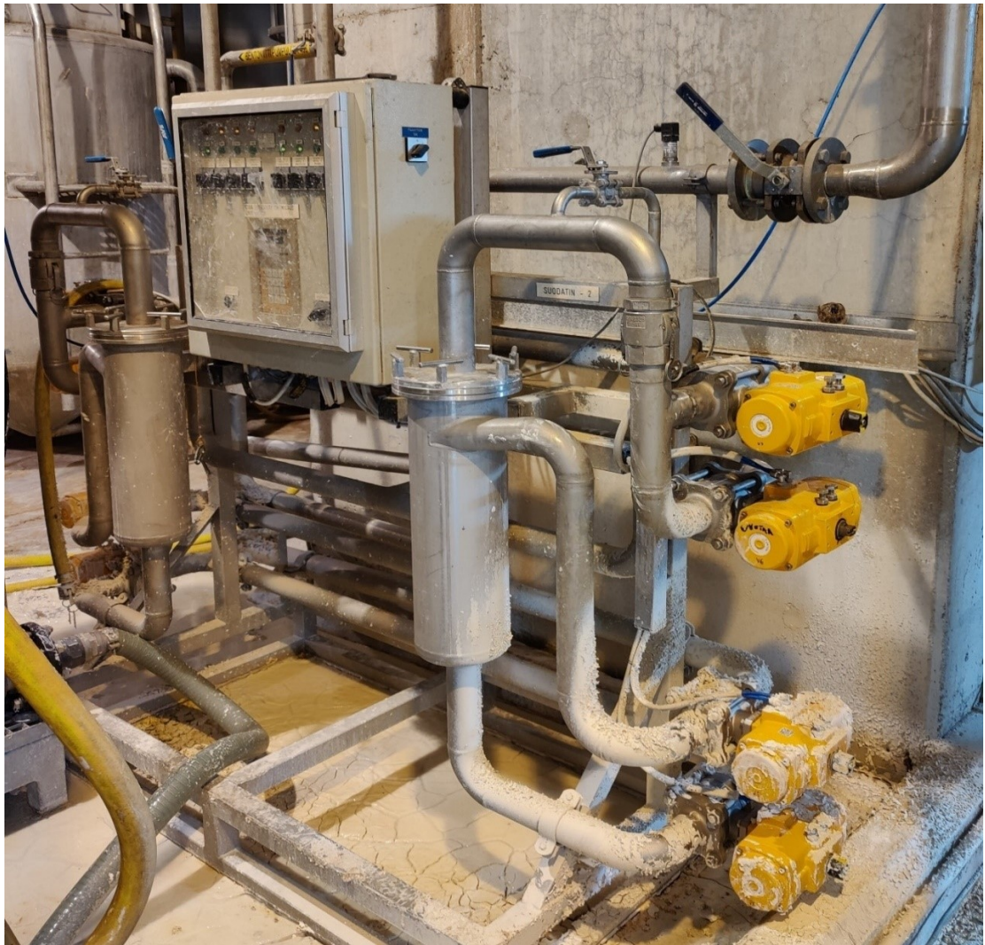
Kuva 4. Bentonitiin suodinlaitteisto (Hirvonen 2022)
