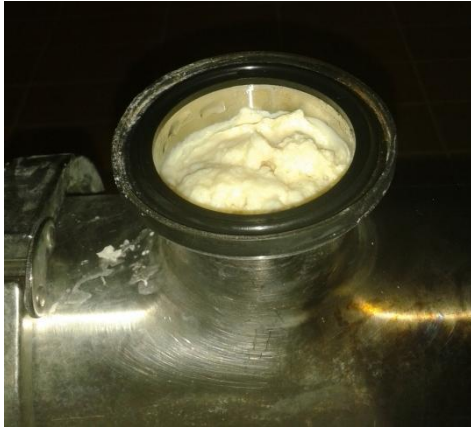
Kuva 7. 5s3-kypsytyssäiliön purkuventtiilille kulkeva putki tuoteajon jälkeen.
