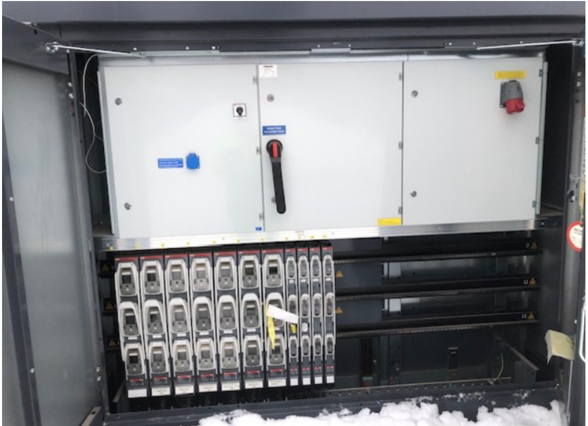
Kuvio 21. Esimerkkikuva muuntoaseman PJ -keskuksesta
