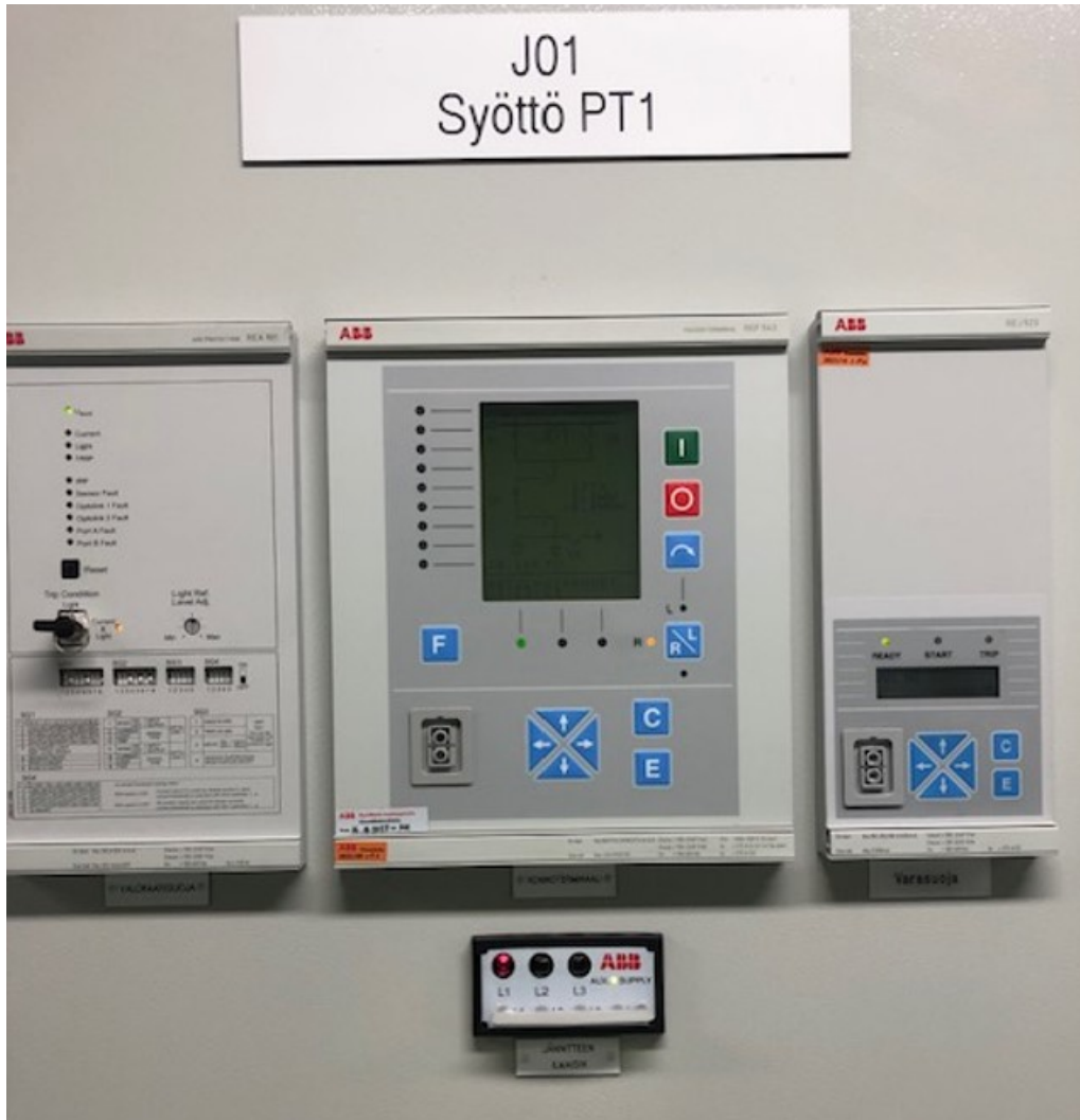
Kuvio 16. ABB REA 101 -valokaarisuoja, REF 543 -syötönsuoja ja REJ 523 -ylivirtasuojaja
