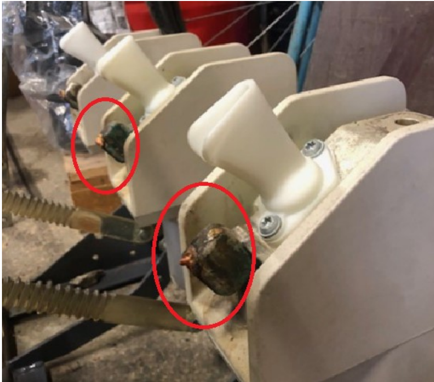
Kuvio 36. ABB NAL 24-6 -kuormaerotin rikkoontuneena, mikä näkyy kipinäineestä koskettimen pinnasta
