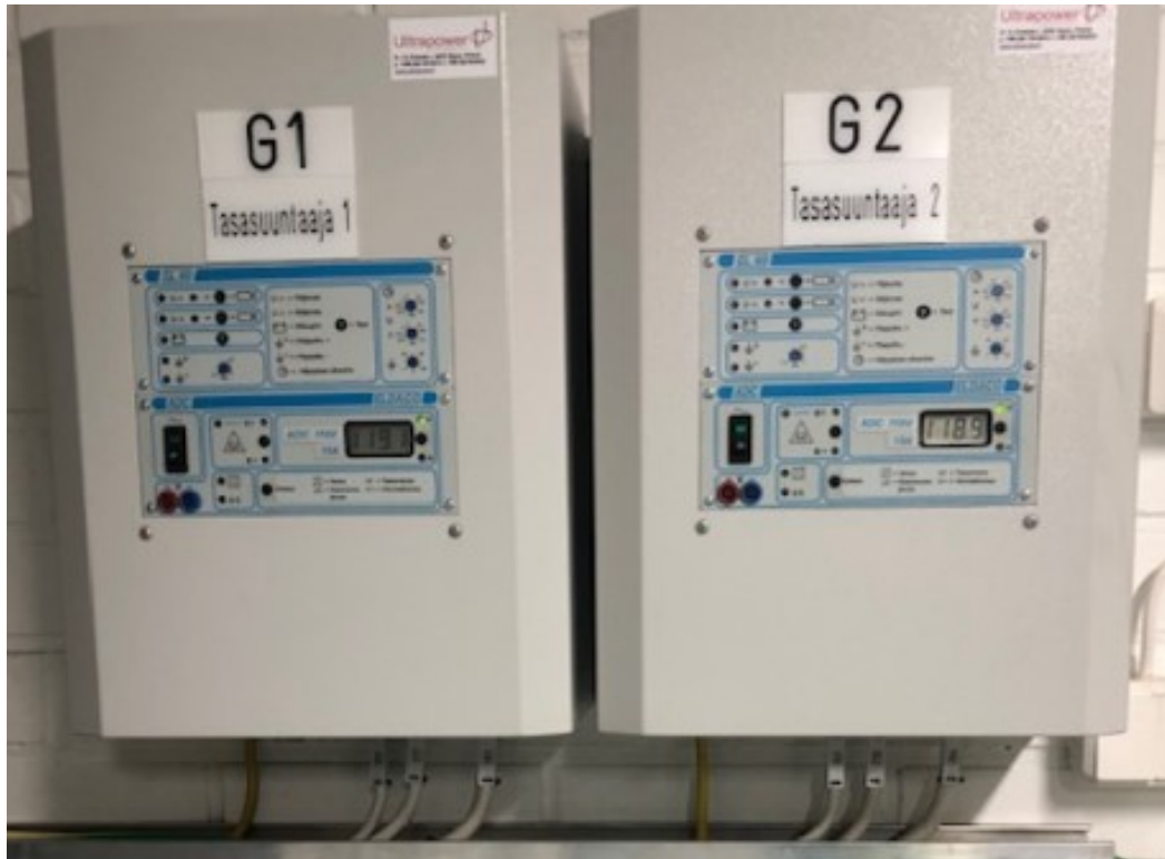
Kuvio 17. Sähköaseman tasasähkökeskuksen 110 VDC -tasasuuntaajat
