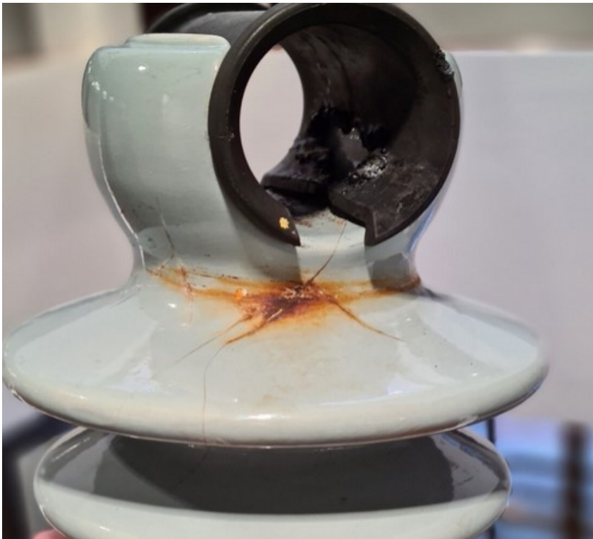
Kuvio 31. Rikkoontunut Enston SDI 37 -eristin (PSK-sähkönsiirto Oy 2024)
