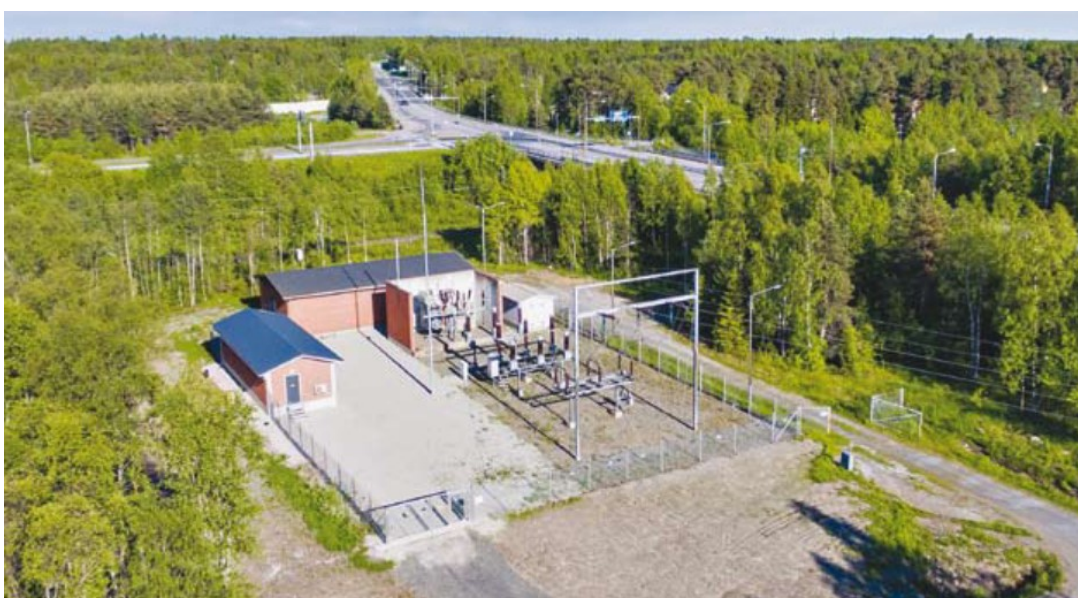
Kuvio 1. Karihaaran sähköasema (Kemin Energia ja Vesi Oy)
