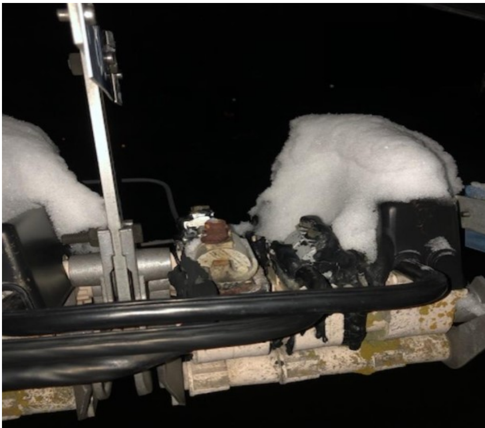
Kuvio 37. Enston pylväsvarokekytkin, missä kosketussuoja sulanut
