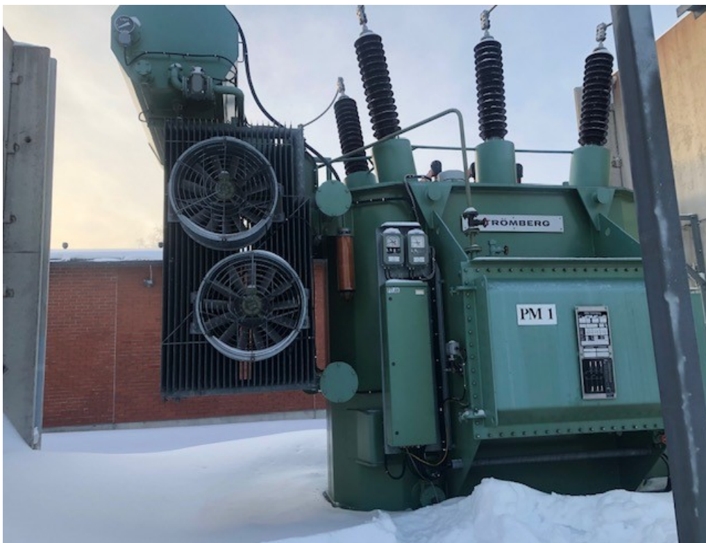
Kuvio 11. 110 kV/20 kV:n Strömberg 25 MVA:n päämuuntaja 1 Syväkankaan sähköasemalta
