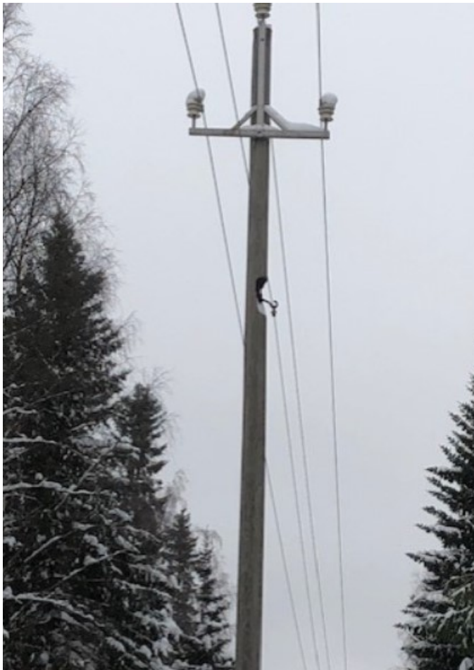
Kuvio 29. Eristinvaurioinen pylväs melkein poikki palaneena
