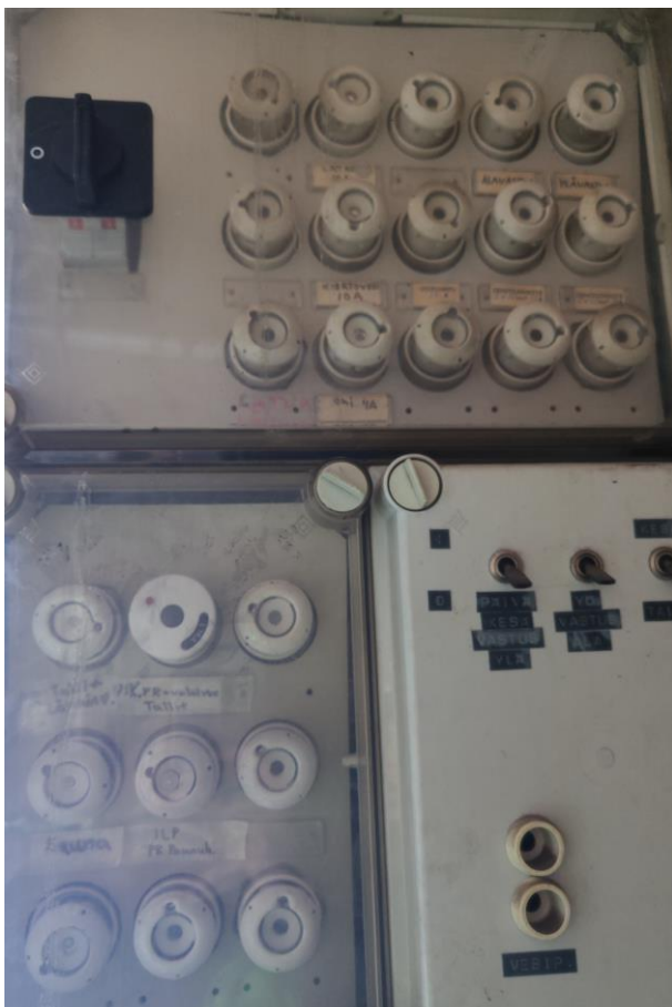
KUVA 2. Autotallia syöttävä keskus.
