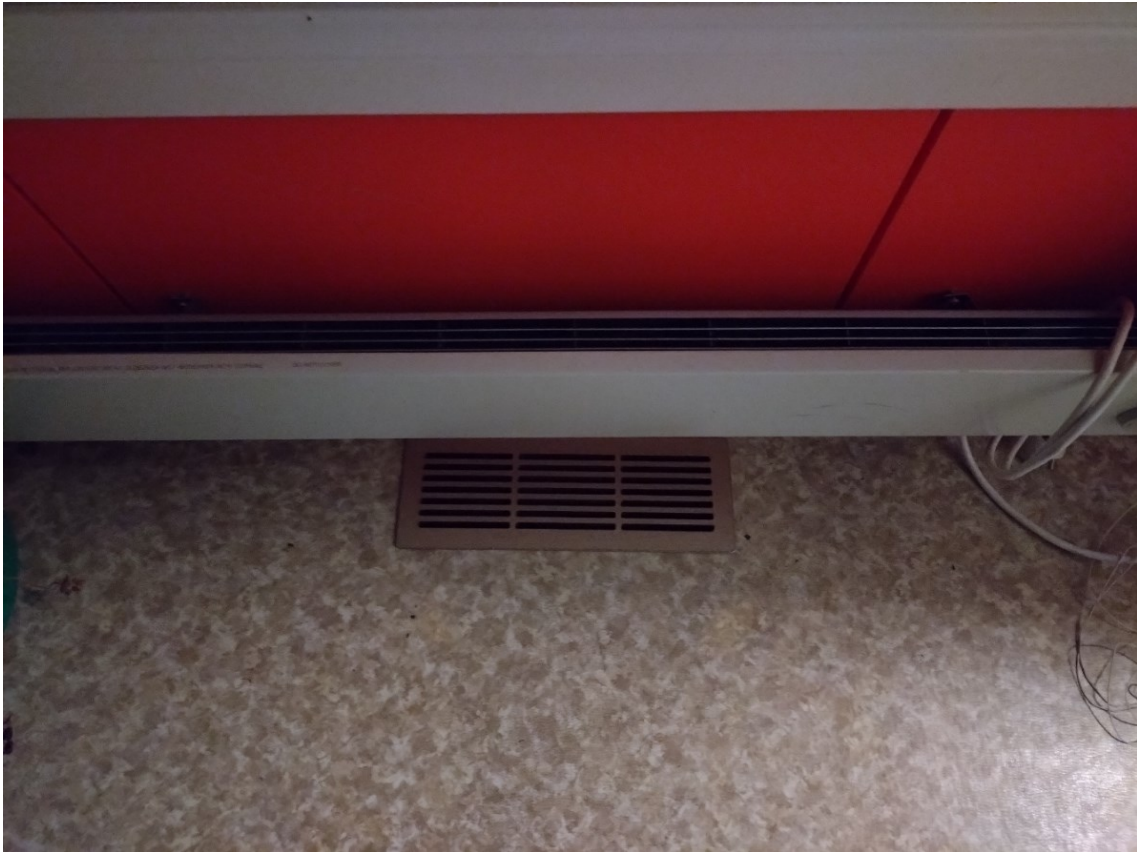
KUVA 11. Lämmönjakojärjestelmään kuuluva venttiili metalliritalän alla
