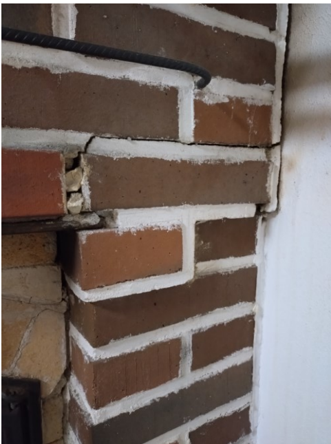
KUVA 13. Leivinuunin yläosan vaurio
