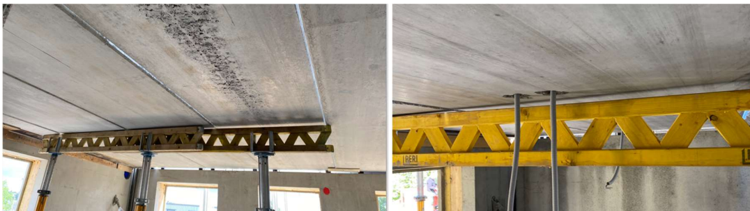
Kuvat 19 ja 20. Laatuvirheitä elementeissä
