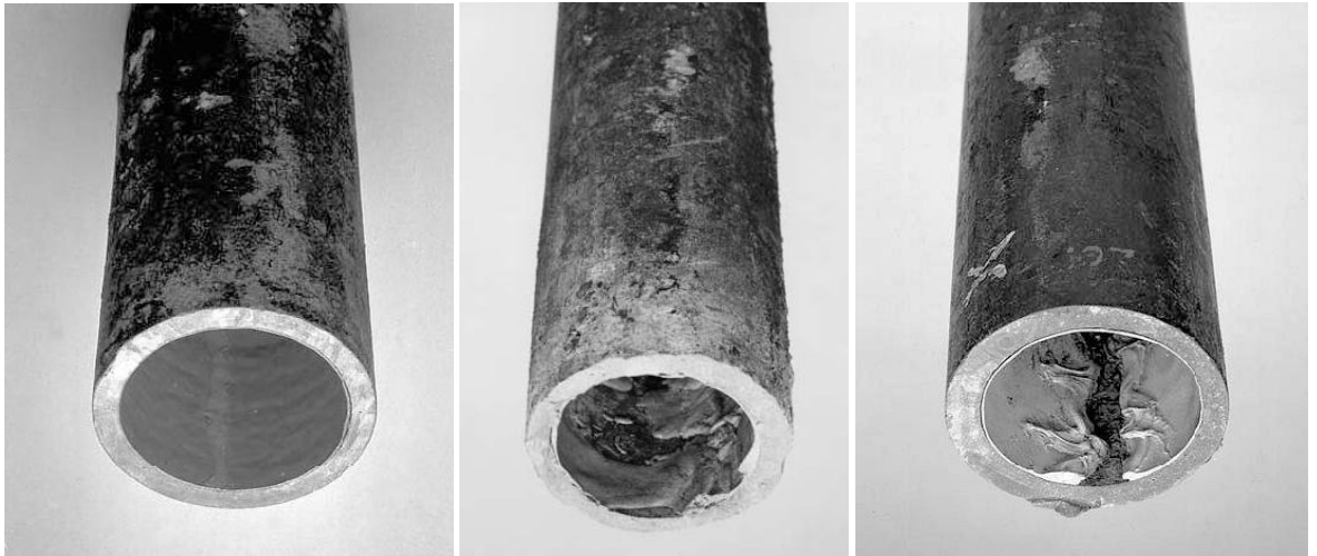
Kuva 5.5 Pinnoittaminen kosteaan/märkään putkeen vaikuttaa pinnoitteen kiinnittymiseen. Kuvassa vasemmalla on vähäinen veden aiheuttama pinnoitteen vaurio, kuvissa keskellä ja oikealla pinnoite on pahasti vaurioitunut putkessa olleen veden vuoksi (Water UK 2009).
