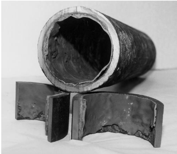
Kuva 5.1 Putki on pinnoitettu huonosti puhdistetulle pinnalle ja pinnoitus on epäonnistunut (Water UK 2009).
